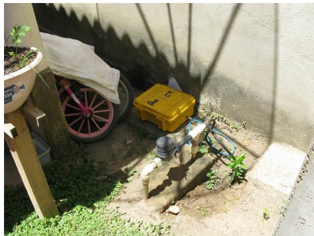
Figura 2 - Equipamento de medição instalado no Ponto 02 - Município de Nova Venécia, ES
