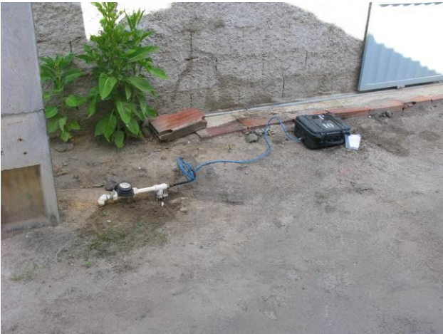
Figura 7 – Equipamento de medição instalado no Ponto 07 – Município de Nova Venécia, ES.
