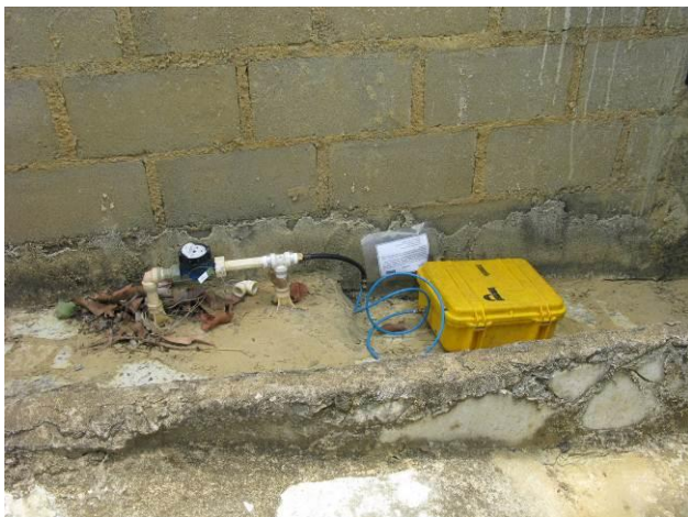
Figura 1 - Equipamento de medição instalado no Ponto 01 - Município da Nova Venécia, ES
