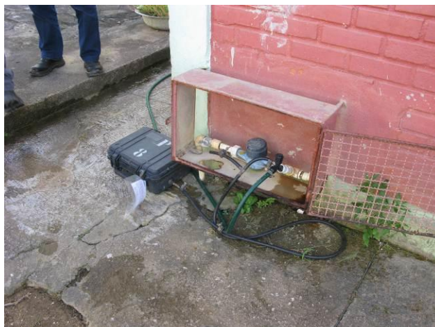
Figura 6 - Equipamento de medição instalado no Ponto 06 - Município de Nova Venécia, ES.
