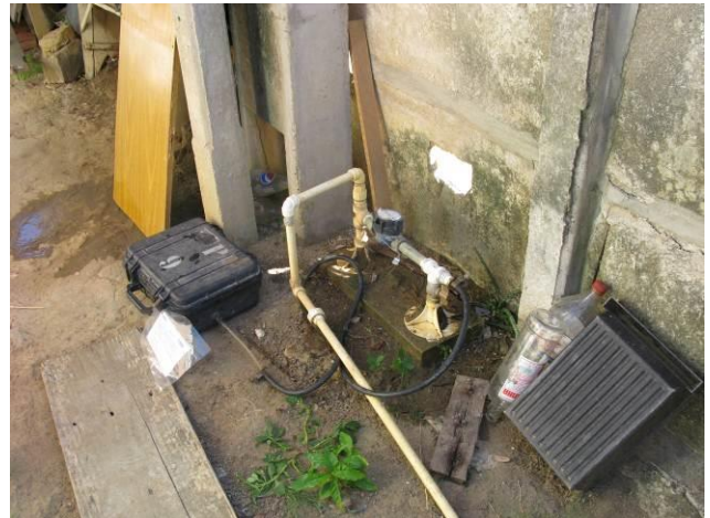
Figura 8 – Equipamento de medição instalado no Ponto 08 – Município de Nova Venécia, ES.
