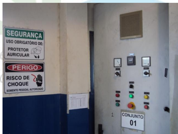
Figura 6: Quadro de comando
