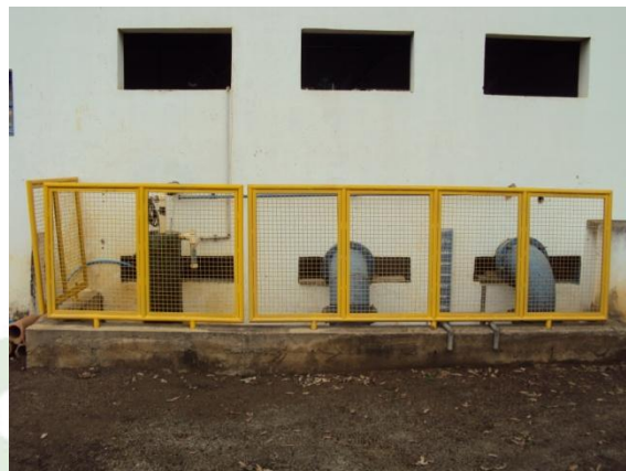
Figura 4: Poço de Sucção
