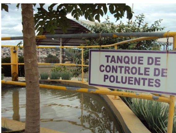
Figura 17: Tanque de Controle de Poluentes
