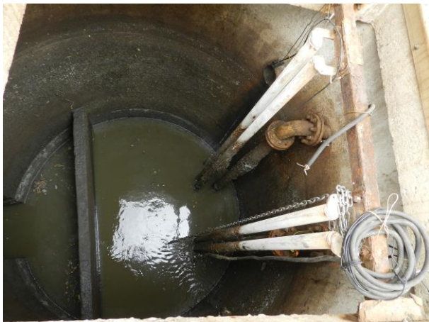
Figura 3 - EEEB da ETE Piaçú.
