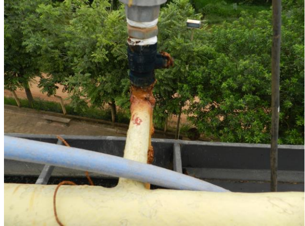
Figura 11 - Tubulação do queimador de gases.
