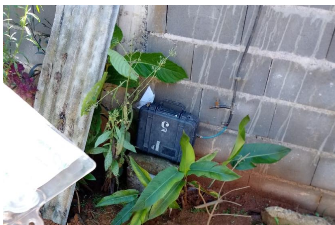
Figura 5 - Equipamento de medição instalado no Ponto 05 - Município de Marechal Floriano, ES
