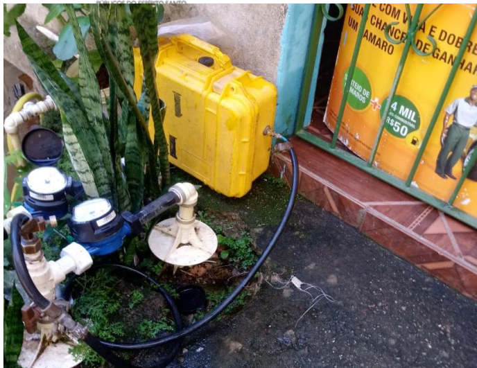
Figura 1 - Equipamento de medição instalado no Ponto 01 - Município de Marechal Floriano, ES
