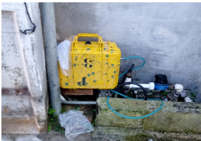
Figura 3 - Equipamento de medição instalado no Ponto 03 - Município de Marechal Floriano, ES
