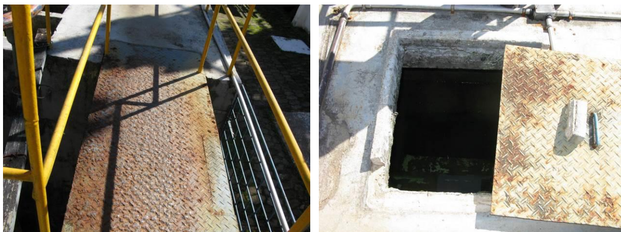
Figura 3 - ETA Marechal Floriano.
