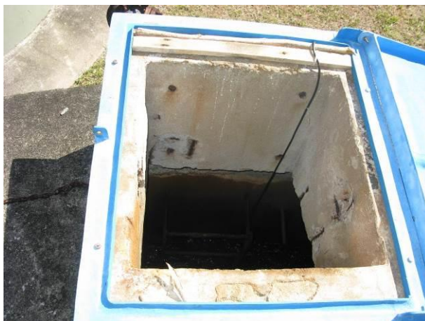
Figura 10 - Reservatório de Marechal Floriano.
