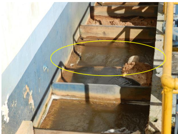
Figura 1- ETA de Marechal Floriano.
