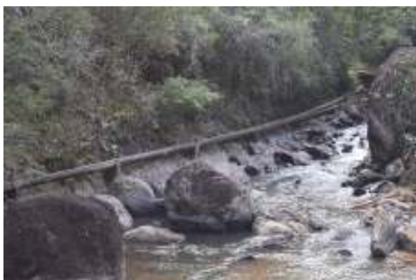
Figura 1- Adutora de água bruta de Marechal Floriano.
