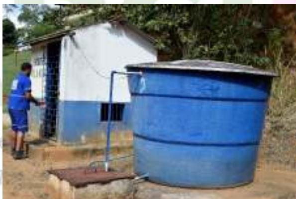
Figura 71 - Reservatório anexo à EEAT Vila Nova.
