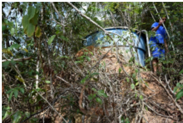
Figura 70 - Reservatório de 10000 litros sem isolamento e identificação e com excesso de vegetação no entorno.
