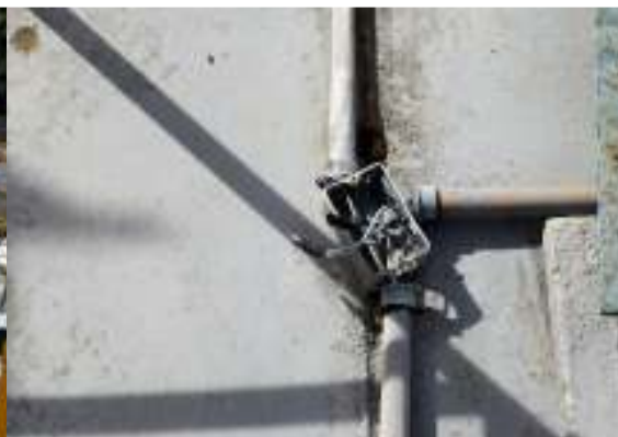
Figura 16 – Fiação exposta no entorno dos filtros.
