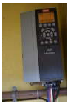
Figura 49- Inversor de frequência do Booster Ronald.
