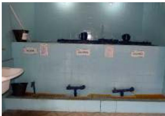
Figura 20: Acondicionamento dos agentes químicos do tratamento (Sulfato de alumínio e Flúor).
