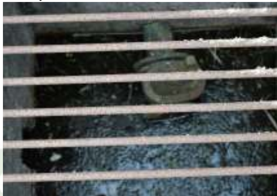
Figura 62 - Acúmulo de resíduos em caixa anexa aos reservatórios.
