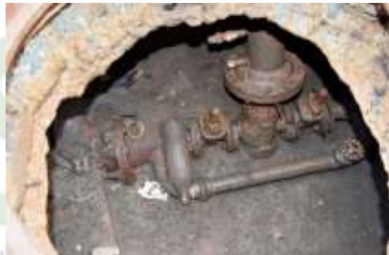
Figura 80 - Válvula redutora de pressão.
