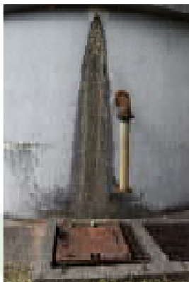
Figura 61 - Tampas enferrujadas em caixas de contenção anexas ao reservatório e indícios de infiltração.
