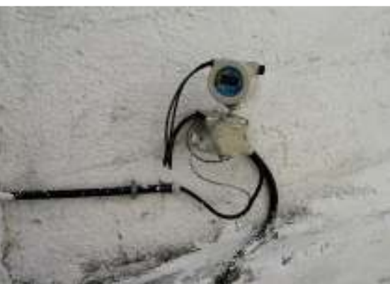
Figura 40 - Pitot de água bruta.
