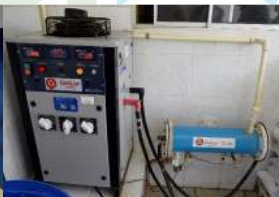
Figura 25 - Equipamento gerador de cloro.
