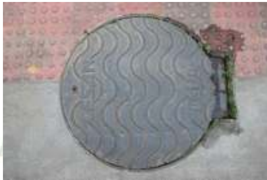
Figura 79: Tampa de proteção com identificação no local em que está instalada a válvula redutora de pressão.
