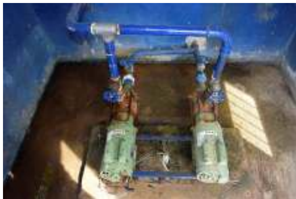
Figura 45 - Conjunto motor-bomba da EEAT Vila Nova.
