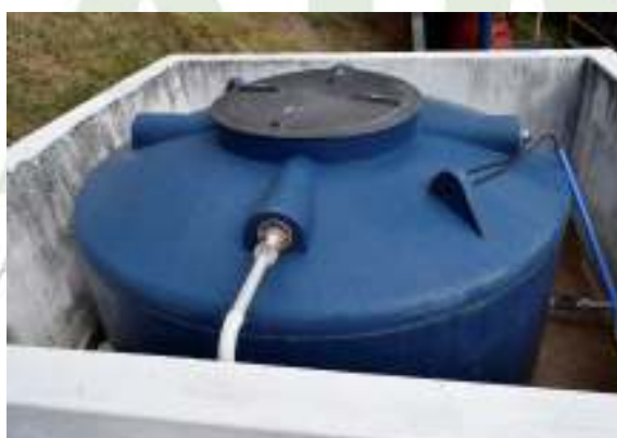
Figura 37 - Armazenamento de cloro.
