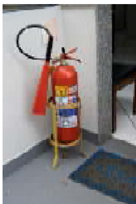
Figura 96 - Extintores disponíveis no escritório de atendimento de Marechal Floriano.
