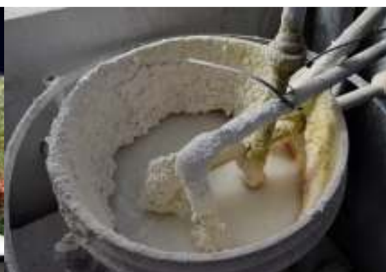
Figura 23 - Dosador de Cal da ETA Marechal Floriano.
