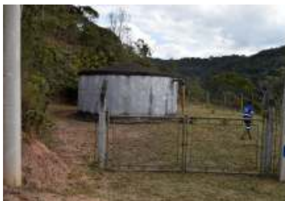
Figura 57 - Entrada dos reservatórios semi-enterrados sem identificação e sem cercamento completo.
