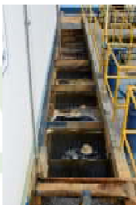
Figura 11: Unidade de Flocação da ETA Marechal Floriano.
