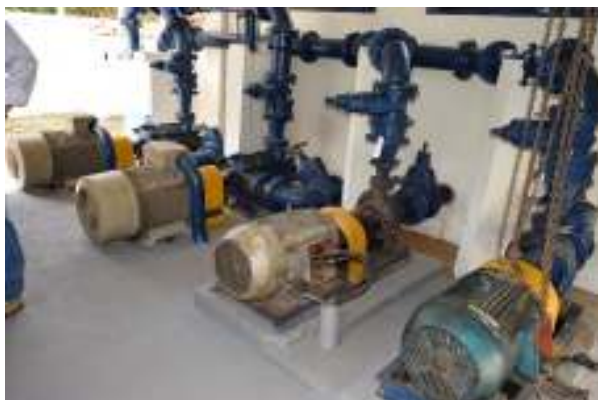
Figura 41 - EEAT localizada na ETA Marechal Floriano.
