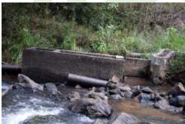
Figura 3 - Estrutura da captação com necessidade de manutenção.
