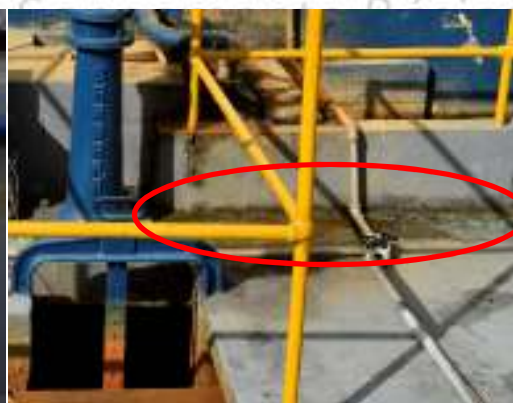
Figura 10 - Infiltração na caixa de chegada.
