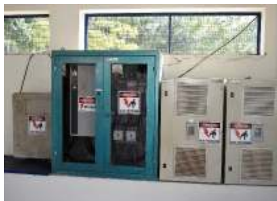
Figura 42 - Painel de controle com sinalização de risco.
