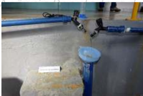
Figura 9 - - Dosador de Sulfato de Alumínio.
