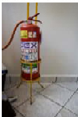
Figura 34 - Extintor de incêndio.
