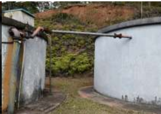
Figura 60 - Tubulações e conexões dos reservatórios enferrujadas.
