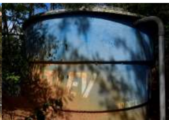
Figura 69 - Reservatório de 10000 litros.
