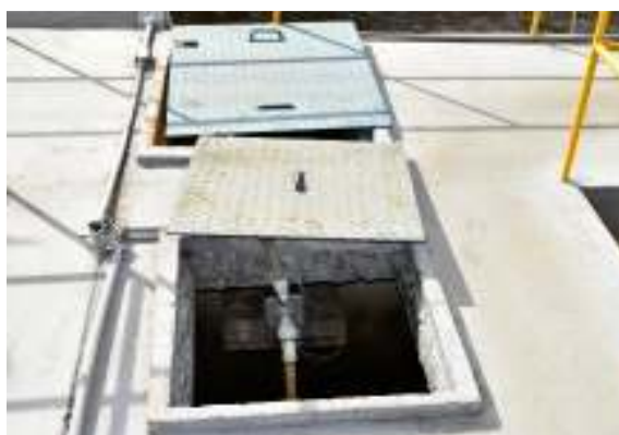
Figura 17 - Tampas abertas na área do entorno dos filtros.
