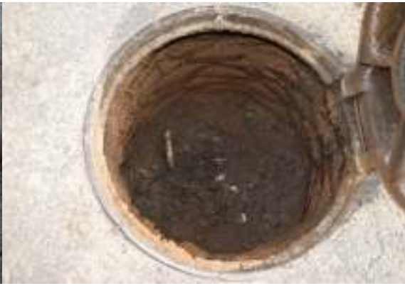
Figura 78 - Descarga 3 com excesso de areia.
