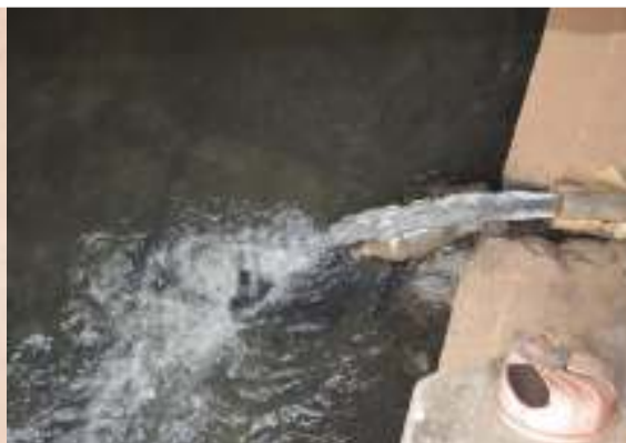
Figura 73: Descarga 1 em operação.
