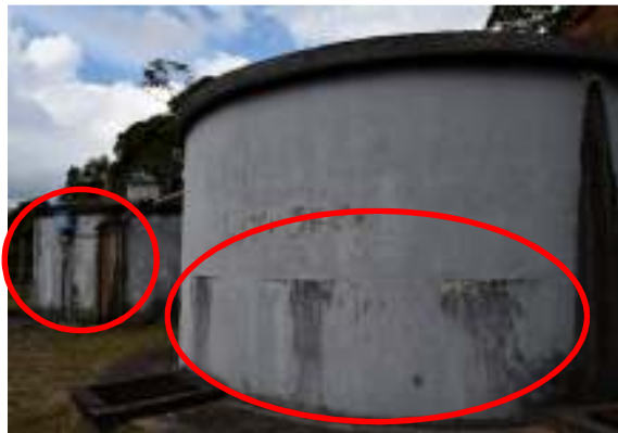
Figura 59 - Infiltrações e desgastes das pinturas na estrutura dos reservatórios.
