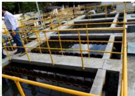
Figura 12: Decantadores da ETA Marechal Floriano.
