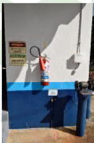
Figura 43 - EEAT da ETA com sinalização e extintor.
