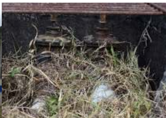
Figura 58 - Excesso de vegetação no entorno dos registros dos reservatórios.
