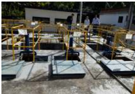
Figura 15 - Filtros da ETA Marechal Floriano.
