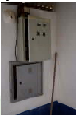
Figura 46 - Painel de controle da EEAT Vila Nova.
