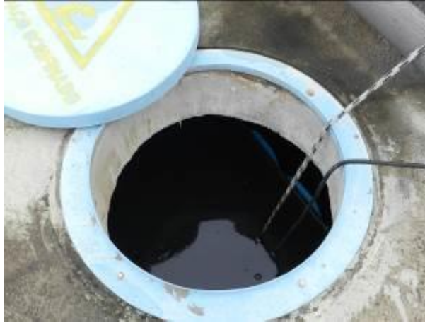
Figura 7 - Bomba no interior do reator 2.
