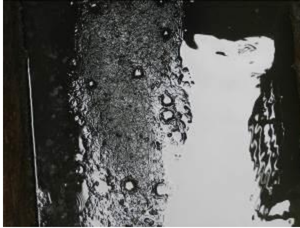
Figura 6 - Interior da caixa de areia da EEEB (Antiga ETE).
