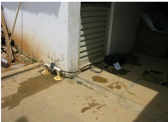
Figura 9- Equipamento de medição instalado no Ponto 07 – Município de Iúna, ES
