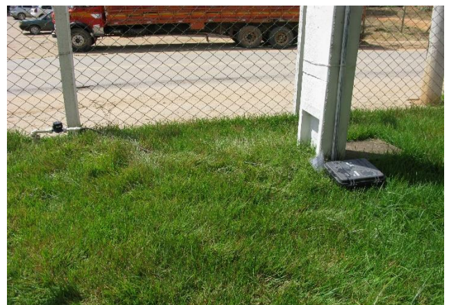
Figura 6 - Equipamento de medição instalado no Ponto 05 - Município de Iúna, ES
