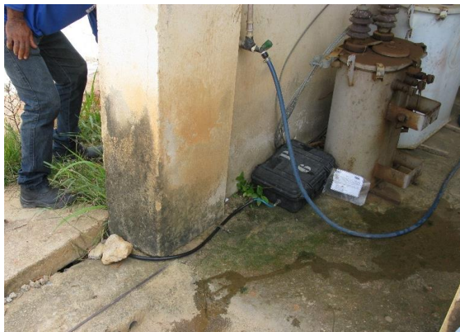
Figura 8- Equipamento de medição instalado no Ponto 06 – Município de Iúna, ES
