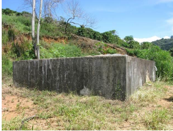
Figura 18 - Ausência de identificação.
