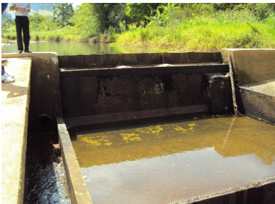
Figura 3: Captação do rio Conceição.
