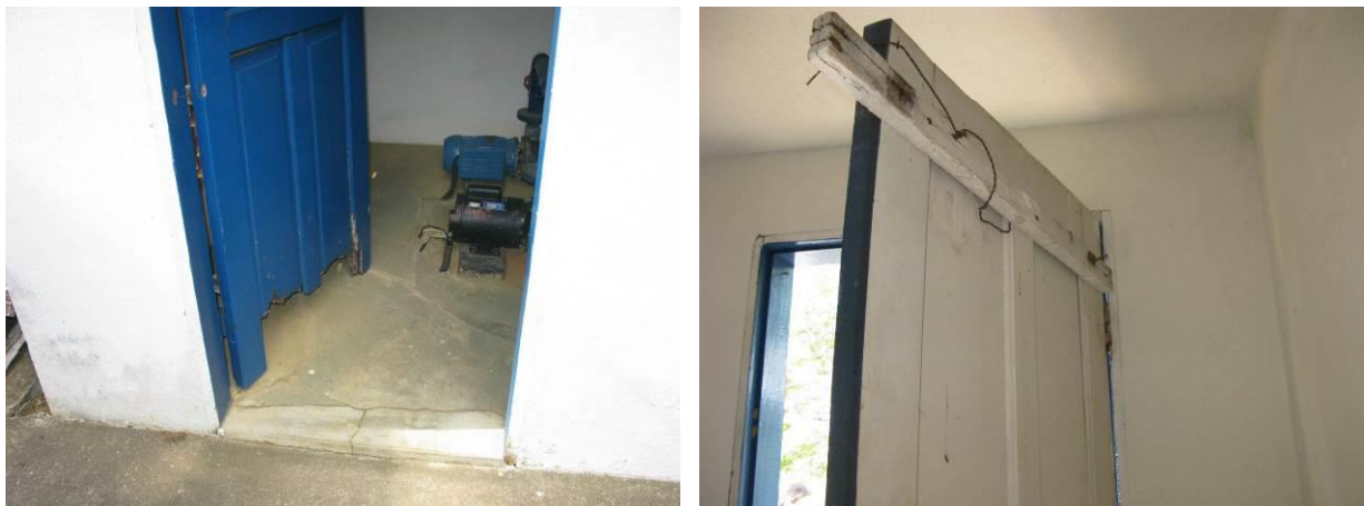
Figura 7 - Porta de acesso à EEAT da ETA de Dores do Rio Preto.
