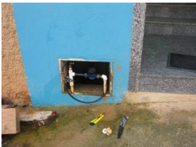
Figura 3 - Equipamento de medição instalado no Ponto 02 - Município de Dores do Rio Preto, ES
