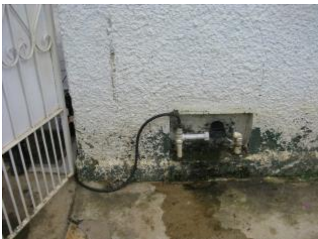
Figura 7 - Equipamento de medição instalado no Ponto 05 – Município de Dores do Rio Preto, ES
