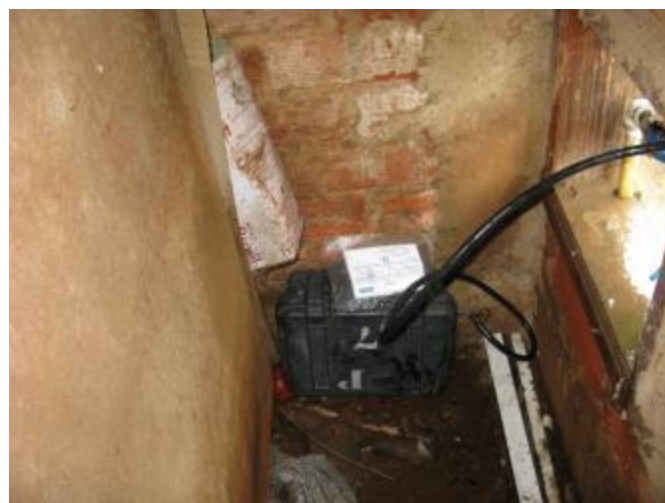
Figura 4 - Equipamento de medição instalado no Ponto 02 - Município de Dores do Rio Preto, ES
