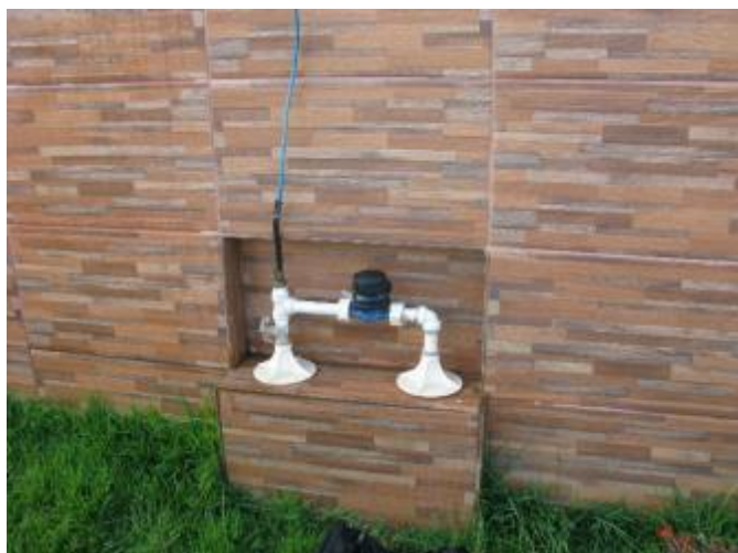
Figura 1 - Equipamento de medição instalado no Ponto 01 - Município de Dores do Rio Preto, ES
