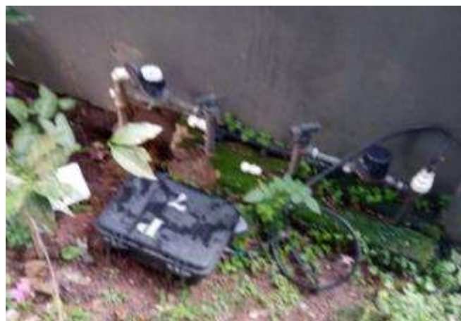
Figura 2 - Equipamento de medição instalado no Ponto 02 - Município de Domingos Martins, ES
