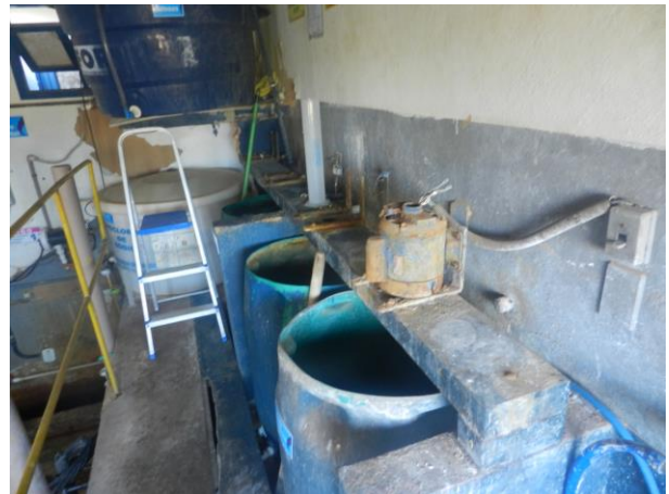
Figura 10 - Agitador mecânicos da sala de dosagem de produtos químicos.
