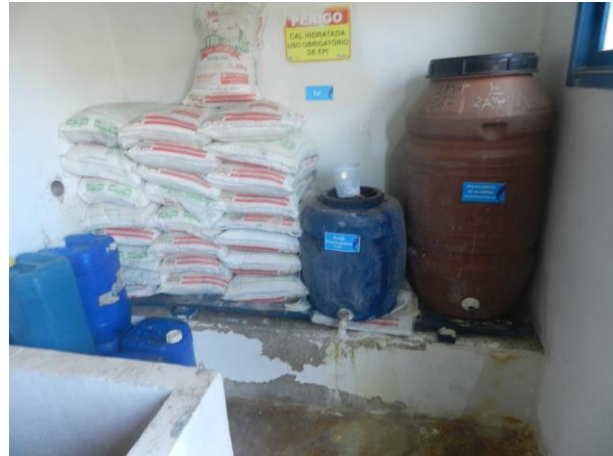
Figura 12 - Armazenamento inadequado Ácido Fluossilícico e Policloreto de Alumínio.
