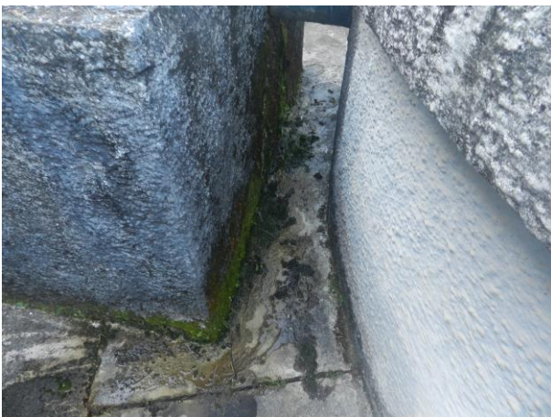
Figura 13 - Infiltração próxima ao tanque de contato.
