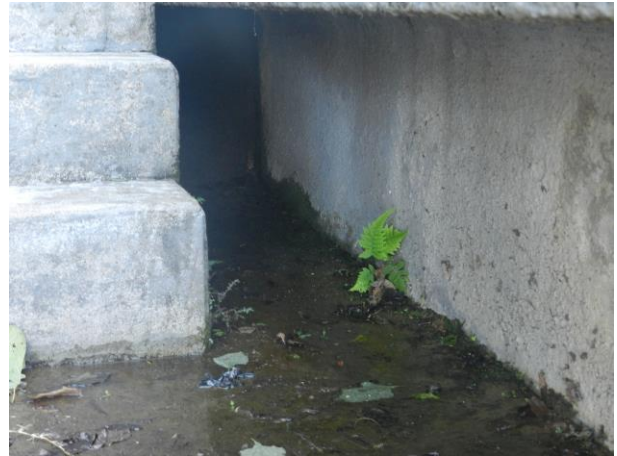
Figura 8 - Infiltrações próximas aos decantadores e floculadores.
