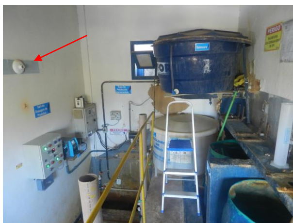
Figura 14 - Sala de dosagem de produtos químicos.
