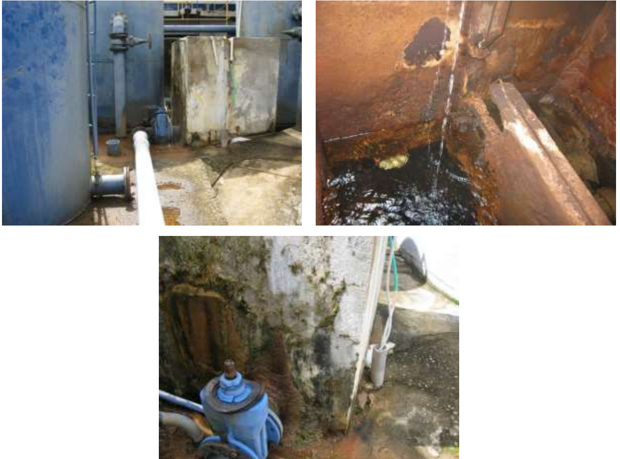
Figura 8 - Tanque de contato da ETA de Conceição do Castelo.
