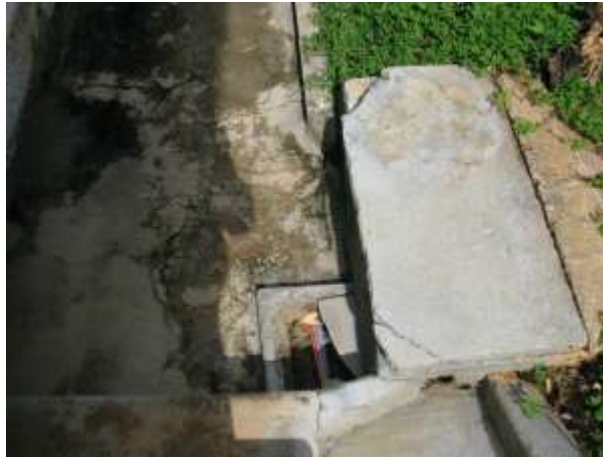
Figura 6 -Ausência de tampa em caixa de passagem .
