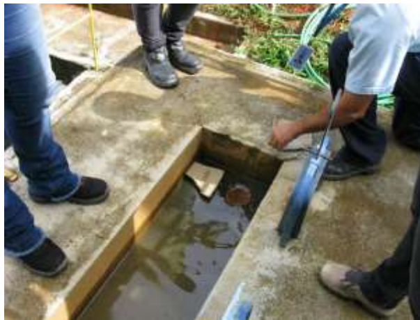
Figura 5 - ETA de Conceição do Castelo.
