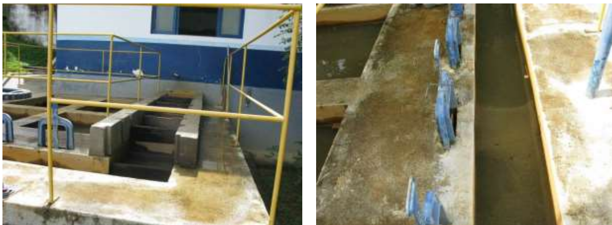
Figura 7 - ETA de Conceição do Castelo.
