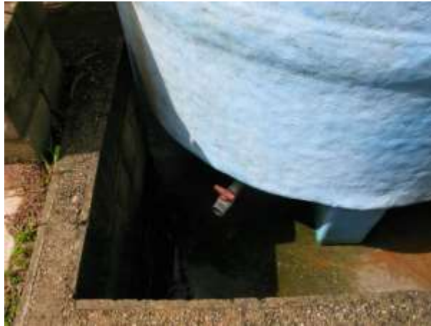
Figura 11 - Vazamento na válvula de descarga de fundo do Filtro 1.
