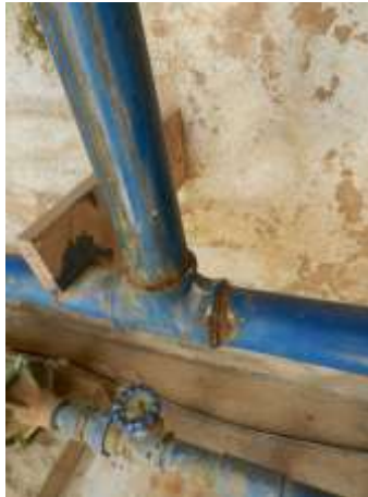
Figura 19 - Tubulações do Booster Larrieu.
