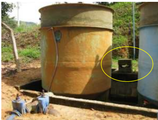
Figura 10 - Ausência de escada de acesso aos filtros .
