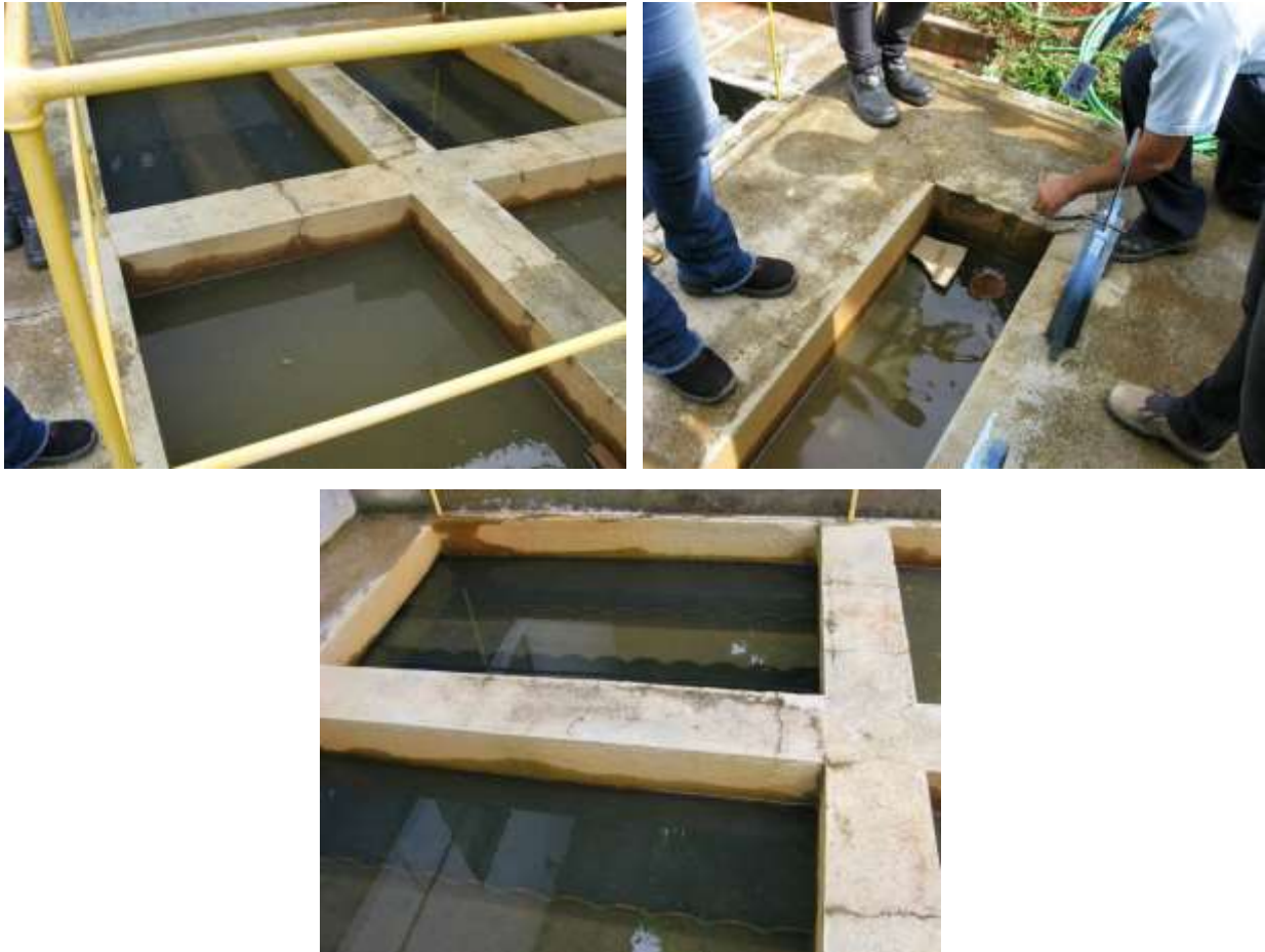
Figura 4 - ETA de Conceição do Castelo .
