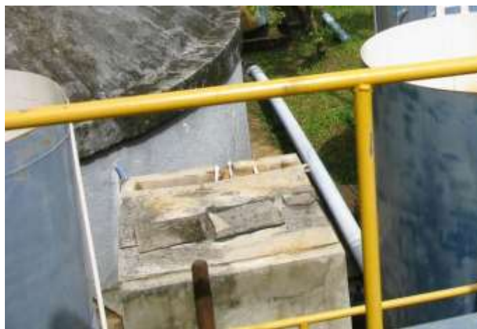
Figura 9 - Cobertura inadequada do tanque de contato.
