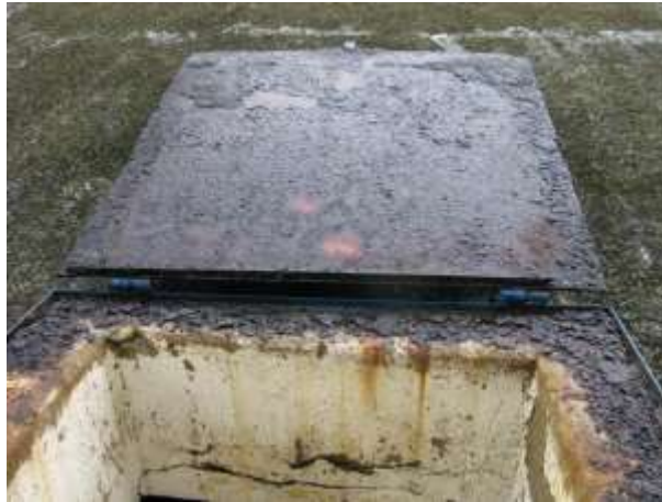
Figura 12 - Tampa enferrujada no reservatório.
