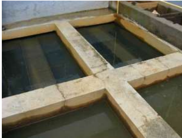
Figura 3 - Decantador da ETA de Conceição do Castelo.
