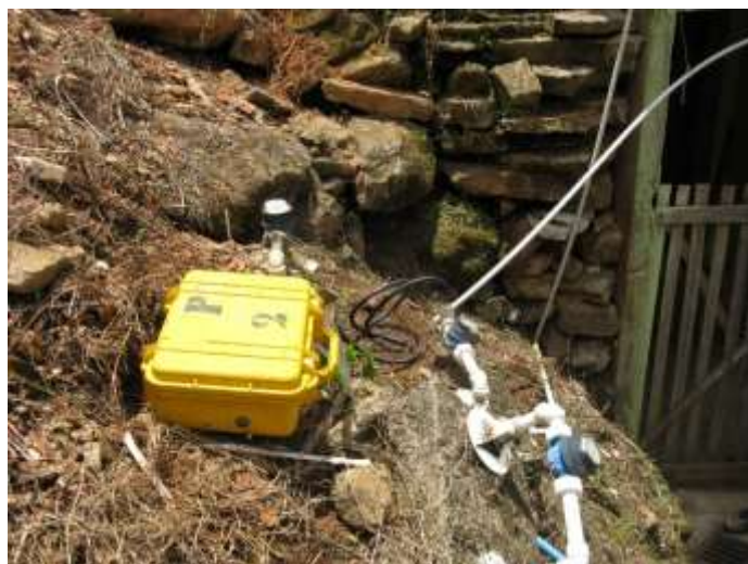
Figura 2 - Equipamento de medição instalado no Ponto 02 - Município de Conceição do Castelo, ES
