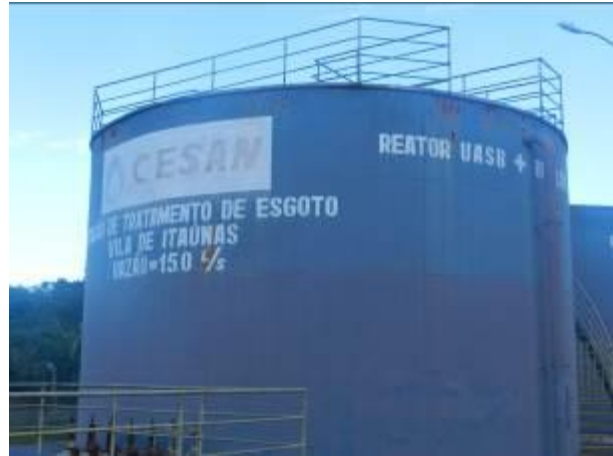
Figura 11 - Reator UASB e Biofiltro.
