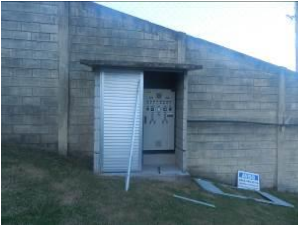
Figura 10 - Painel de comando da EEEB C.
