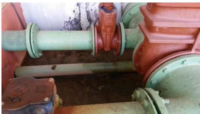
Figura 12 - Válvula de controle de saída do filtro da ETA de Castelo.
