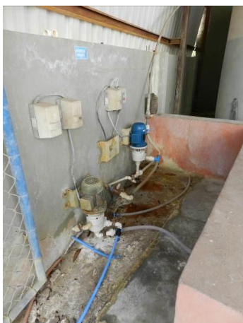
Figura 35 - Bomba de sulfato de alumínio da ETA de Castelo.
