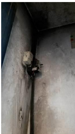
Figura 34 - Painel de comando/controle do Booster Boa Fé (Requiere).
