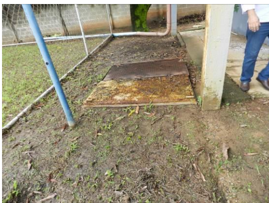
Figura 17 - Tampa enferrujada na área interna.
