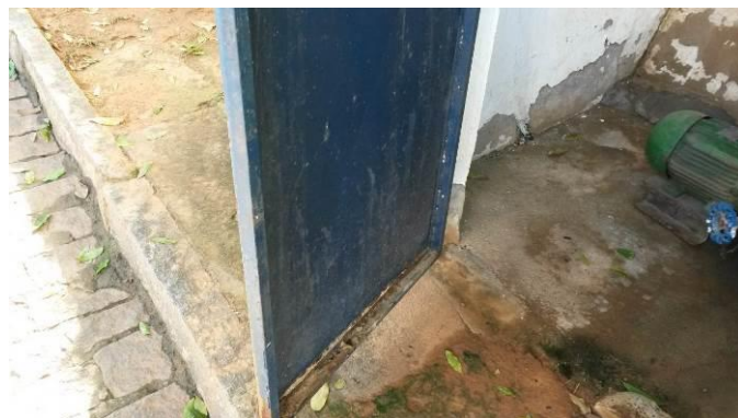
Figura 27 - Booster Bela Vista (Atalanta) – portão enferrujado.
