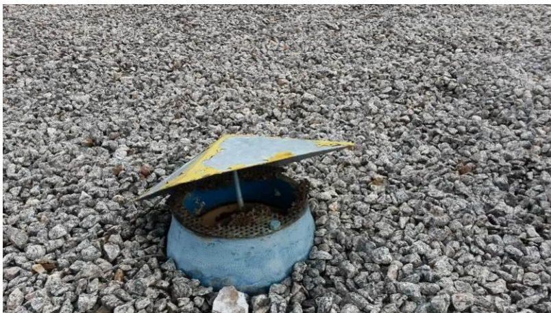
Figura 37 - Dutos de ventilação com telas quebradas.
