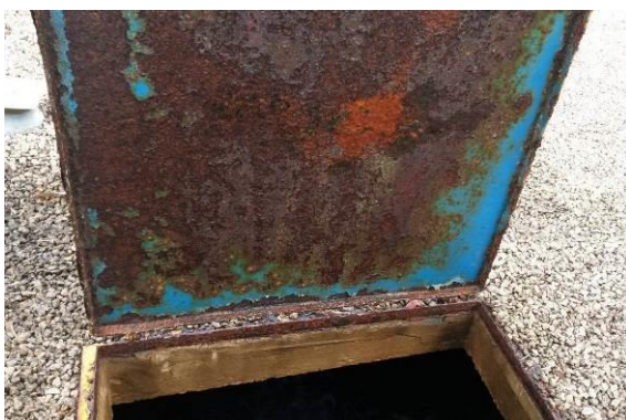
Figura 19 - Tampas enferrujadas no reservatório de 800m³.
