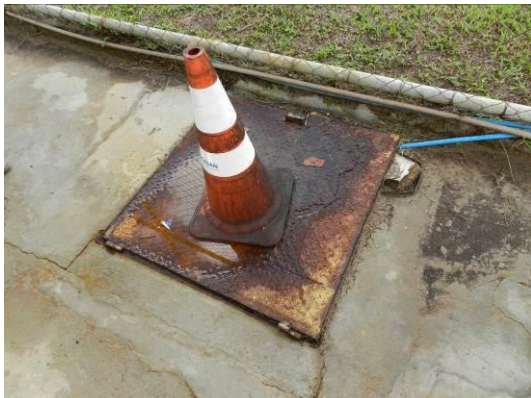
Figura 15 - Tampa enferrujada na área interna.
