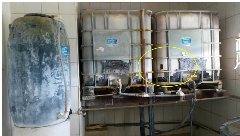
Figura 10 - Tanque de armazenamento de Sulfato de Alumínio da ETA de Castelo.
