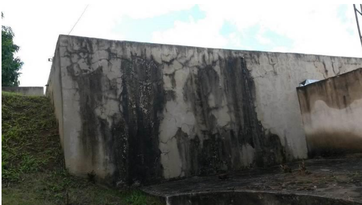
Figura 9 - Reservatório de 800m 3 da ETA de Castelo.
