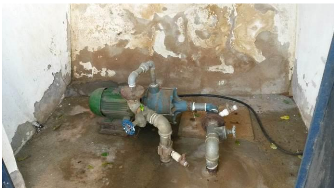
Figura 22 - Booster Bela Vista (Atalanta).
