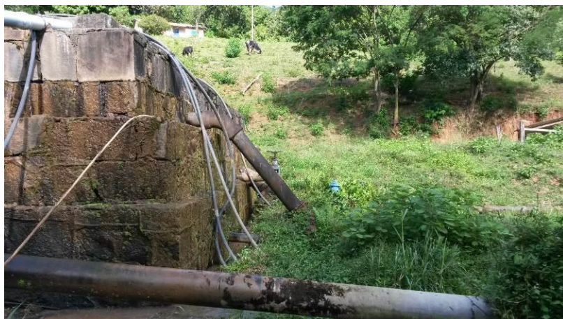
Figura 4 - Captações de terceiros na estrutura da tomada de água e caixa de areia da Captação de Água Bruta do Rio Caxixe.
