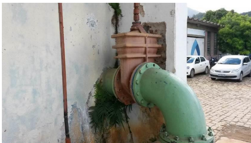
Figura 8 - Há indícios de infiltração e vegetação crescendo na parede do filtro.
