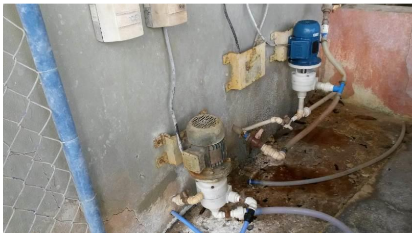
Figura 14 - Há sinais de vazamento na tubulação da bomba de sulfato de alumínio.
