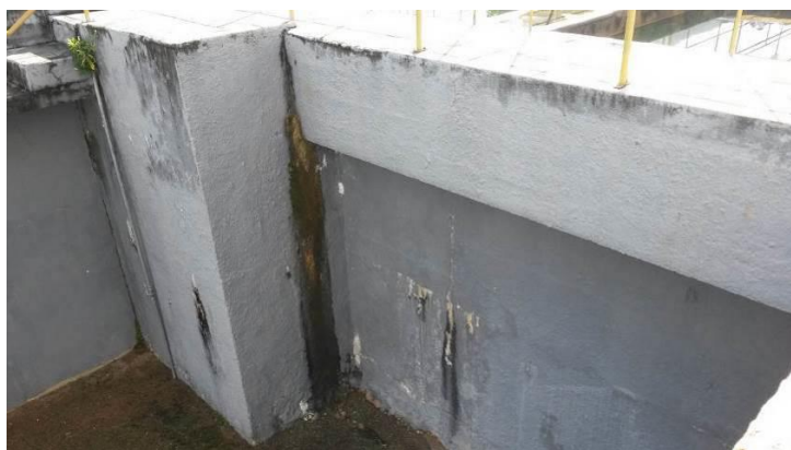
Figura 7 – Infiltração nas paredes do filtro.
