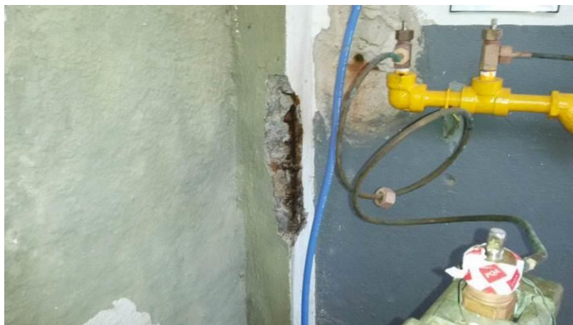
Figura 13 - Há armaduras com sinais de corrosão.
