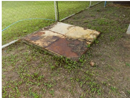
Figura 16 - Tampa enferrujada na área interna.
