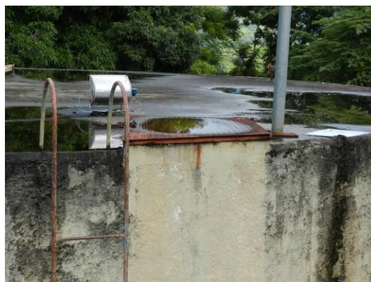
Figura 18 - Tampa enferrujada no reservatório de 730m³.
