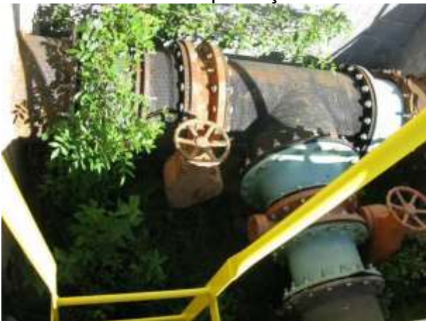
Figura 15 - Caixa de distribuição do Reservatório do Morro do Pico.
