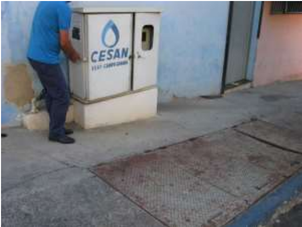
Figura 49 - EEAT Campo Grande.
