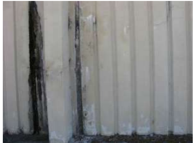
Figura 30 - Reservatório Vale Esperança.
