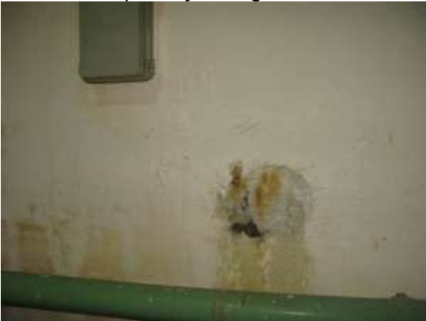
Figura 37 - Nas paredes dos filtros da ETA Vale Esperança Antiga.
