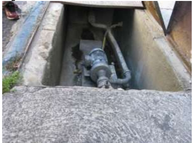
Figura 10 - EEAT Campo Grande.
