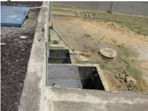
Figura 24 - Reservatório Dido Fontes.
