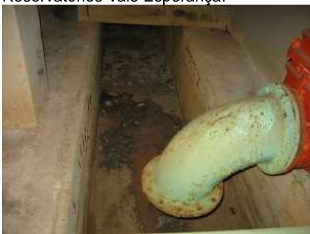
Figura 43 - Sala dos barriletes dos Reservatórios Vale Esperança.
