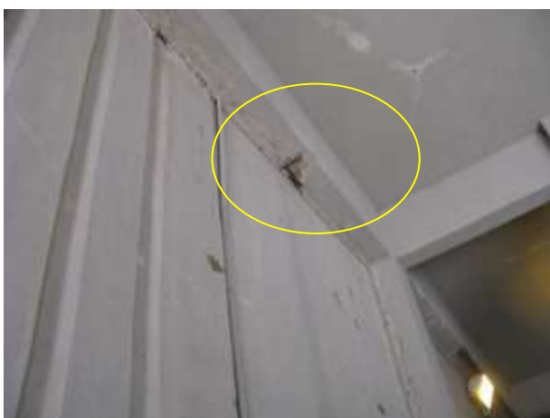
Figura 41 - Sala dos barriletes dos Reservatórios Vale Esperança.
