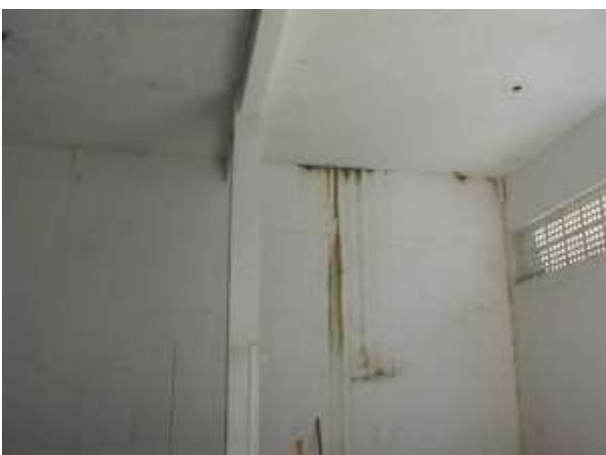
Figura 33 - Sala do barrilete do reservatório de Alto Lage.
