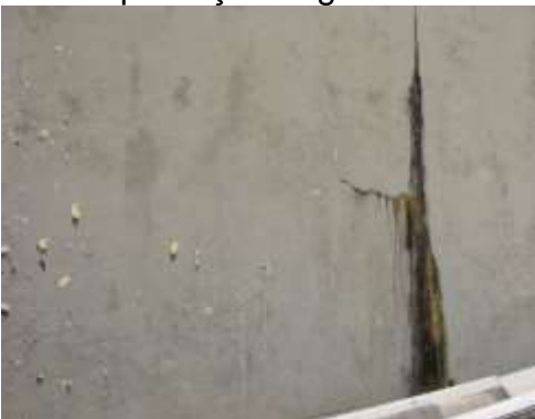
Figura 39 - Parede externa do Reservatório de lavagem de filtros da ETA Vale Esperança.
