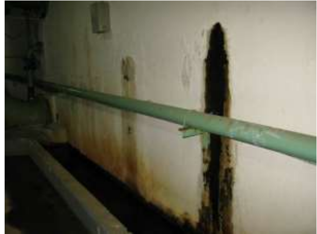
Figura 36 - Nas paredes dos filtros da ETA Vale Esperança Antiga.
