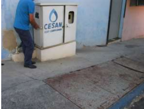
Figura 28 - EEAT Campo Grande.
