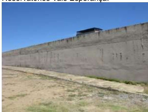
Figura 44 - Reservatório Dido Fontes.
