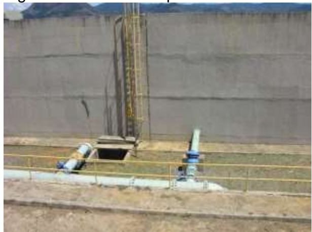
Figura 25 - Reservatório Nova Rosa da Penha.
