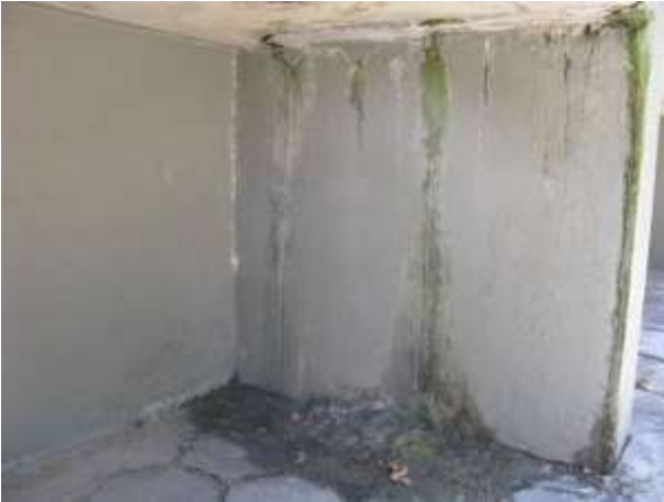
Figura 35 - Laje inferior do flocculador da ETA Vale Esperança Antiga.
