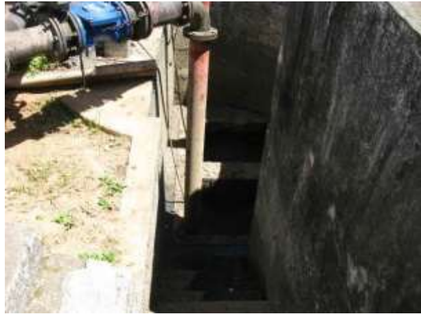
Figura 22 - EEEB Nova Rosa da Penha II (Borracharia), Poço de sucção sem tampa.
