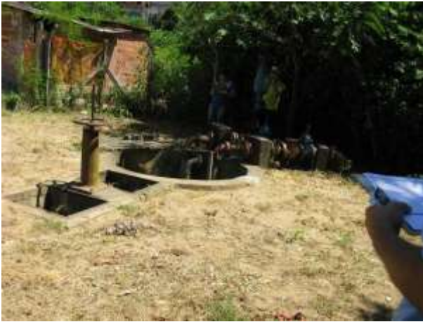
Figura 21 - EEEB Nova Rosa da Penha I (Brejo), Poço, Caixas de Inspeção sem tampas.
