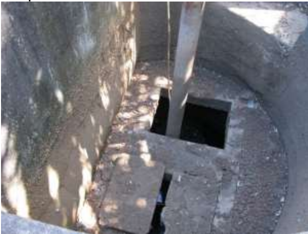
Figura 23 - EEEB Porto Belo.
