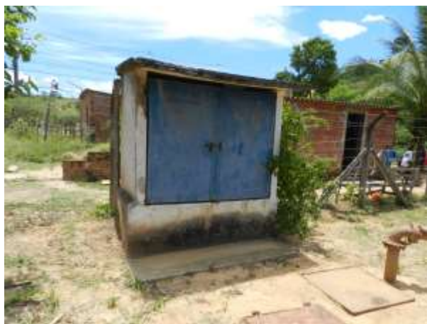
Figura 74 – Abrigo do quadro elétrico da EEEB Padre Gabriel II.
