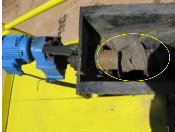
Figura 68 – Furos na rosca da ETE Bandeirantes
