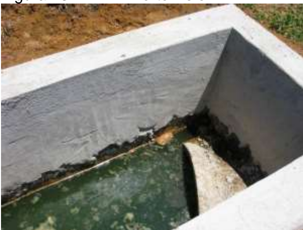
Figura 25 - Caixa de saída do efluente da ETE Nova Rosa da Penha.
