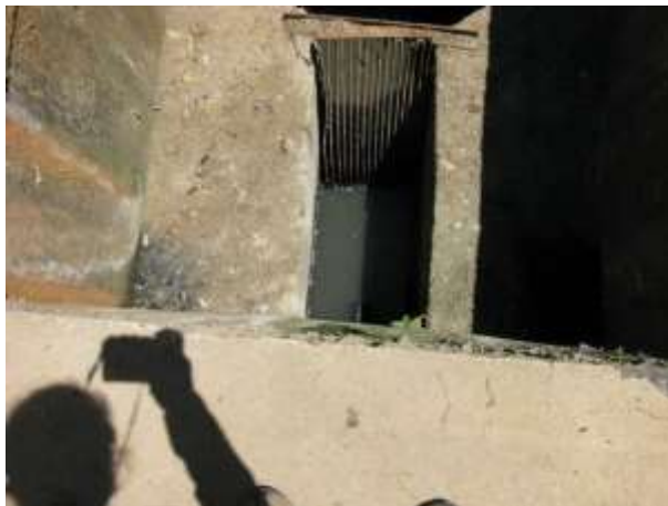
Figura 66 - Gradeamento da EEEB Jardim Botânico (ETE) do S.E.S. Bandeirantes
