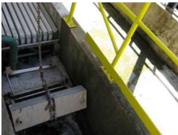
Figura 69 - Sistema Ultra Violeta não funciona na ETE Bandeirantes
