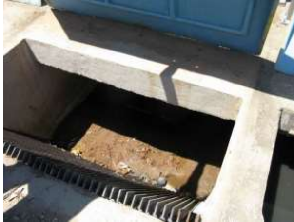
Figura 67 - Acúmulo de areia na caixa de entrada da ETE Bandeirantes
