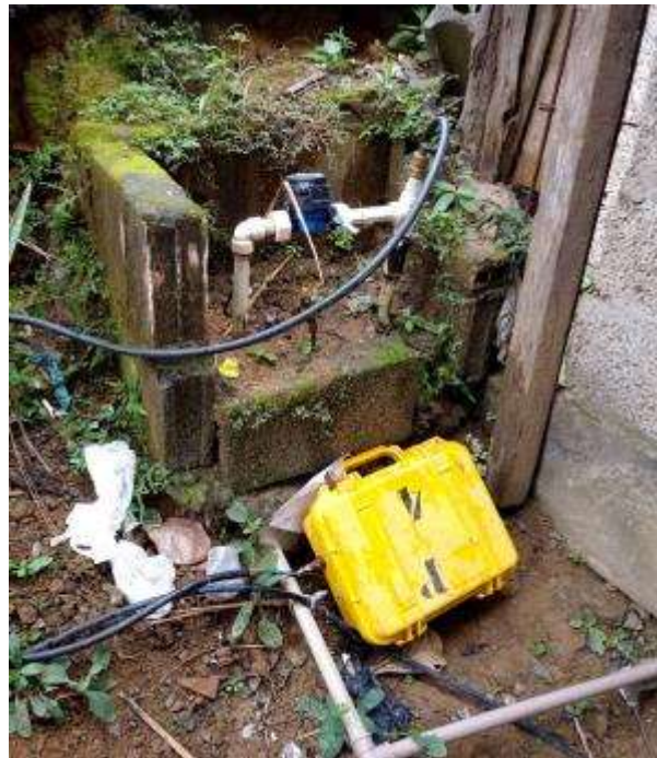
Figura 4 - Equipamento de medição instalado no Ponto 04 - Município de Cariacica, ES
