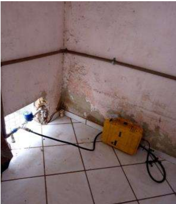
Figura 11 - Equipamento de medição instalado no Ponto 11 – Município de Cariacica, ES
