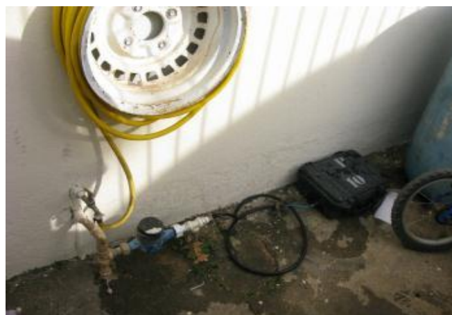
Figura 6 - Equipamento de medição instalado no
