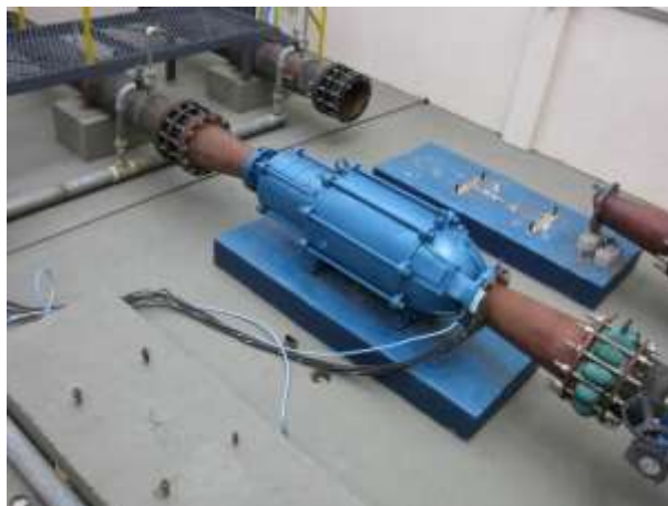
Figura 1 - Ausência de bomba reserva.
