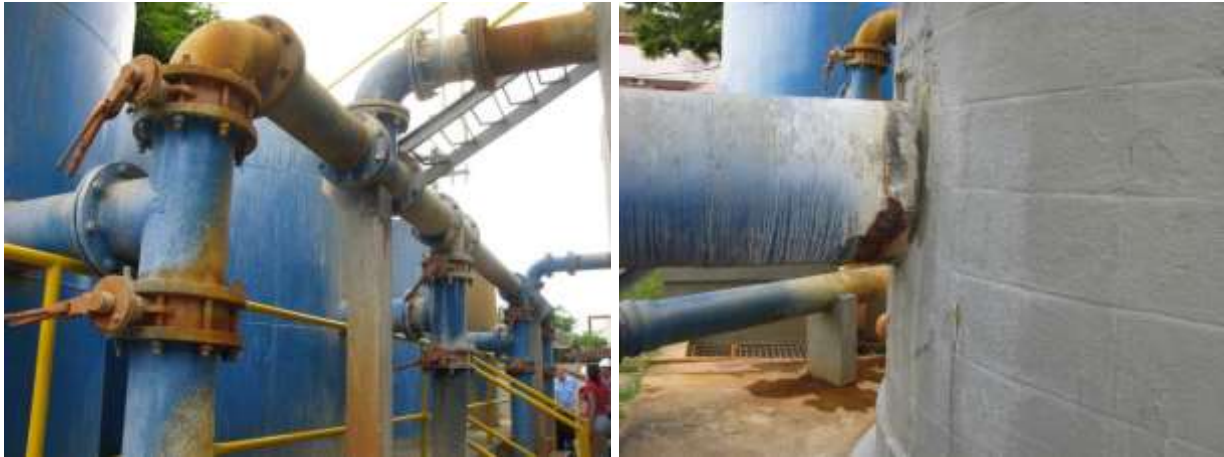
Figura 4 - Tubulações necessitam de manutenção.
