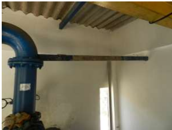
Figura 2 - Ausência ancoragem adequada.
