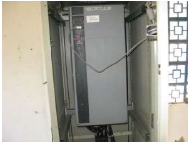
Figura 6 - Ausência de sinalização de risco de choque elétrico.
