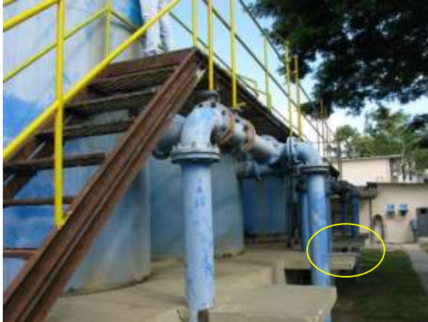
Figura 3 – Sinais de infiltração nos decantadores e reservatório, e vazamento na válvula de lavagem dos filtros.
