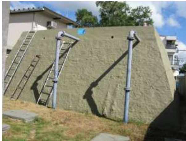
Figura 9 - Ausência de escada de acesso adequada ao reservatório.
