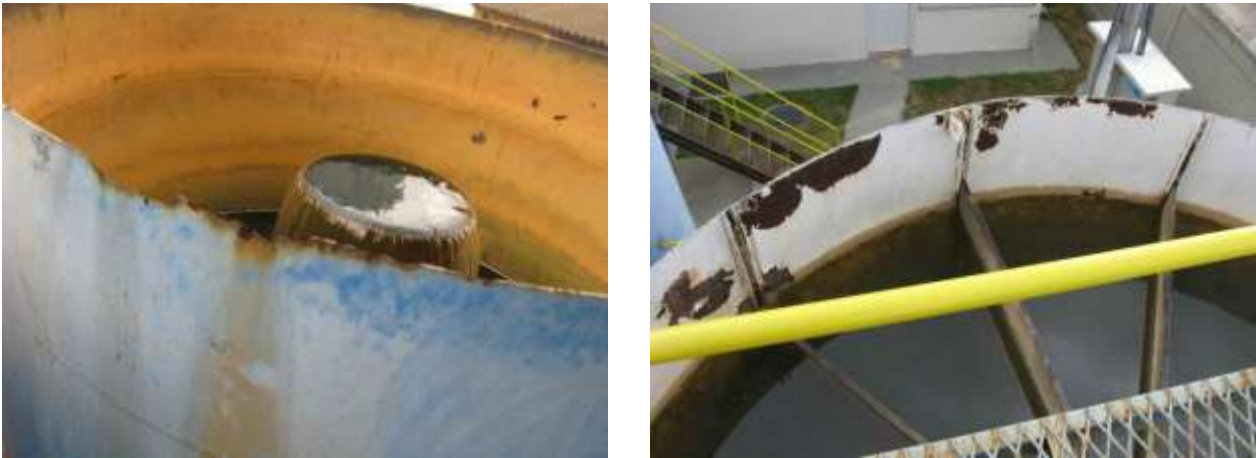
Figura 5 - Sinais de corrosão.
