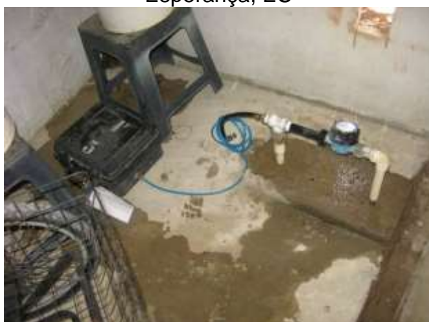
Figura 5 - Equipamento de medição instalado no Ponto 05 - Município de Boa Esperança, ES.
