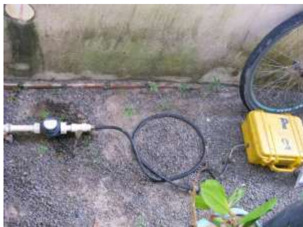
Figura 2 - Equipamento de medição instalado no Ponto 02 - Município de Boa Esperança, ES
