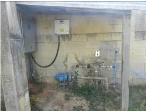
Figura 1 - Booster abrigo dos velhos.
