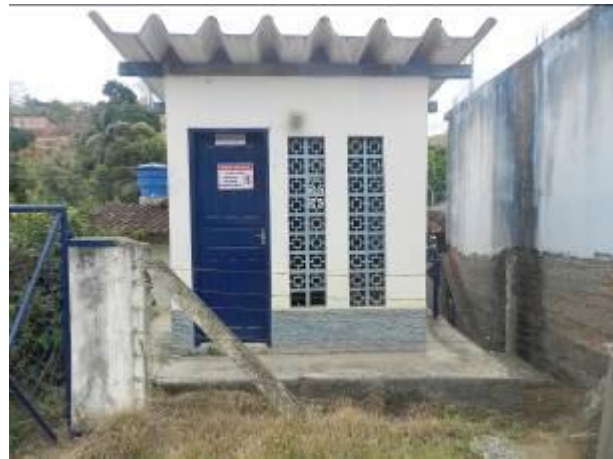
Figura 21 - Booster Loteamento Vila dos Anjos.
