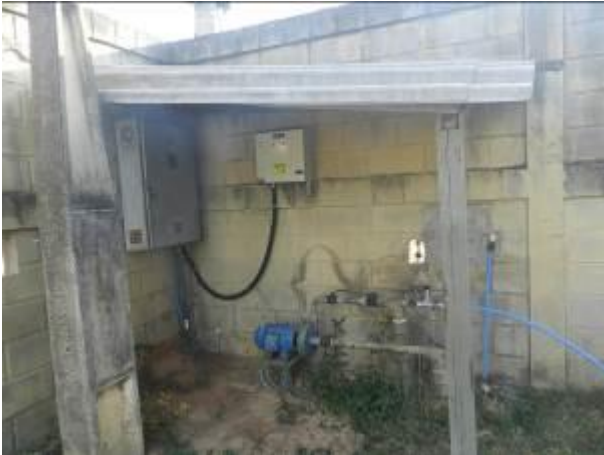
Figura 7 - Booster abrigo dos velhos.
