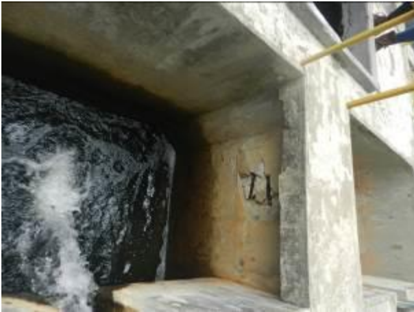
Figura 11 - Filtros da ETA Vila Paulista.
