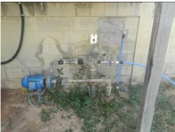
Figura 18 - Booster Abrigo dos Velhos.
