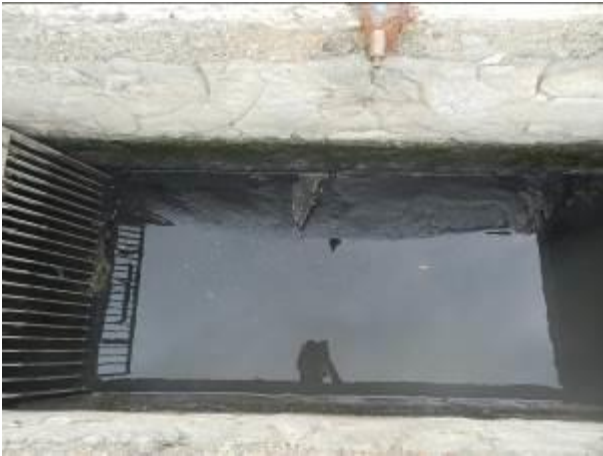
Figura 5 - Tratamento preliminar da ETE.
