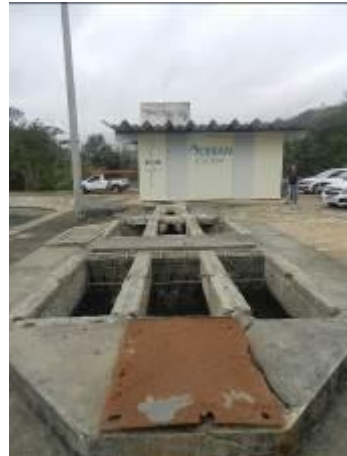
Figura 6 - Tratamento preliminar da ETE.
