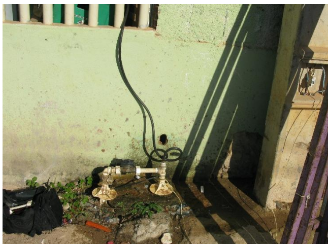
Figura 1 - Equipamento de medição instalado no Ponto 01 - Município de Atílio Vivacqua, ES
