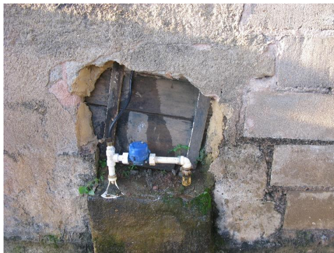
Figura 6 - Equipamento de medição instalado no Ponto 05 – Município de Atílio Vivacqua, ES
