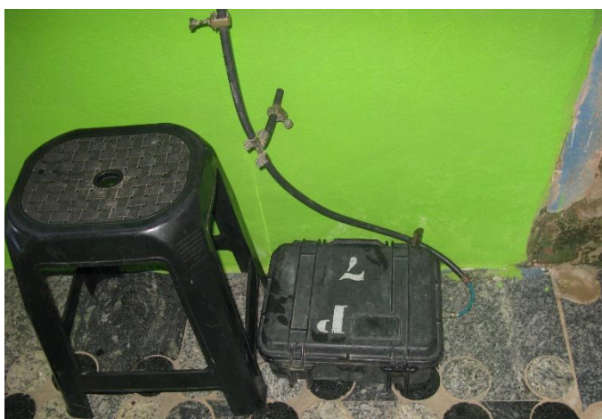
Figura 4 - Equipamento de medição instalado no Ponto 02 - Município de Atílio Vivacqua, ES
