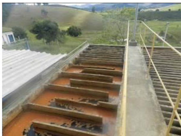
Figura 14 – Flocculador ETA Alto Rio Novo.
