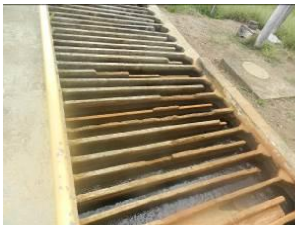
Figura 15 – Flocculador ETA Alto Rio Novo.
