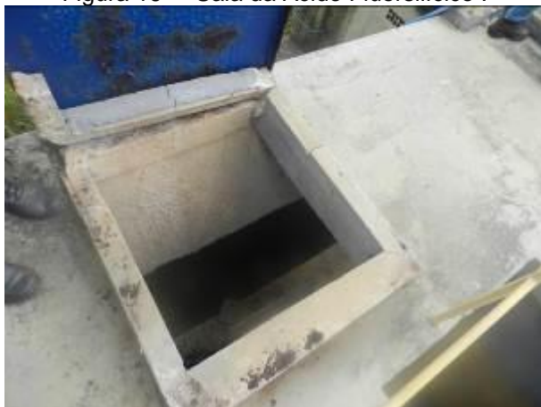
Figura 18 - Acesso ao tanque de contato.
