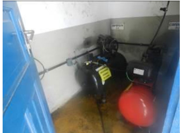
Figura 10 – Sala de compressores da ETA Alto Rio Novo.
