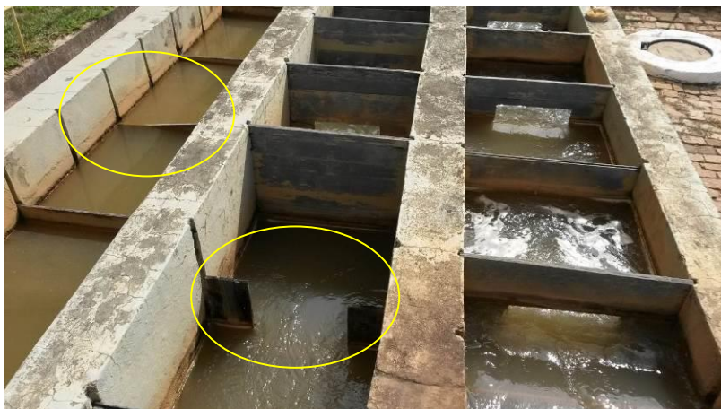
Figura 1- Flocculador da ETA Afonso Cláudio.
