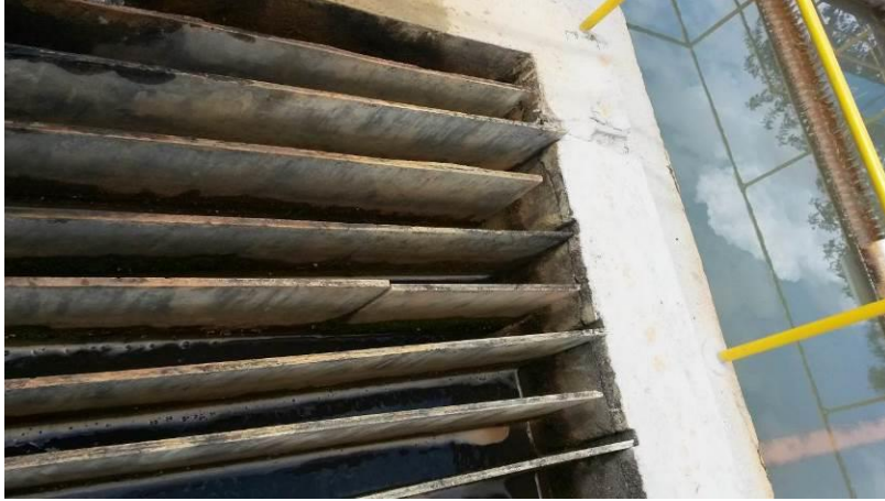
Figura 2 - Flocculador da ETA Serra Pelada.
