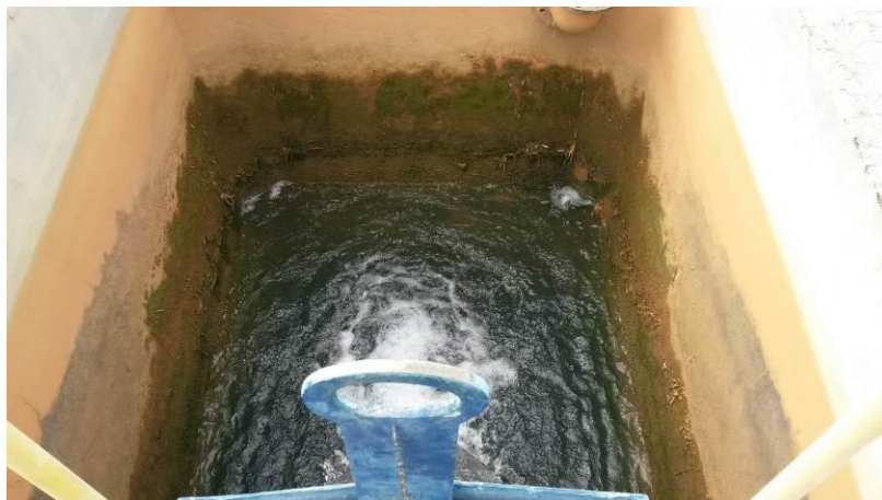
Figura 3 - Filtros da ETA de Afonso Cláudio.
