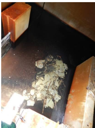
Figura 7 –Tanque de contato da ETA de Afonso Cláudio – sede
