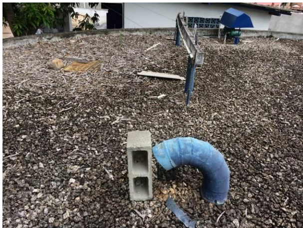
Figura 9 - Reservatório (400m 3 ) da ETA de Afonso Cláudio
