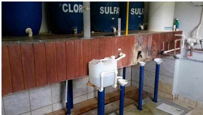
Figura 8 - Dosadoras da ETA Serra Pelada
