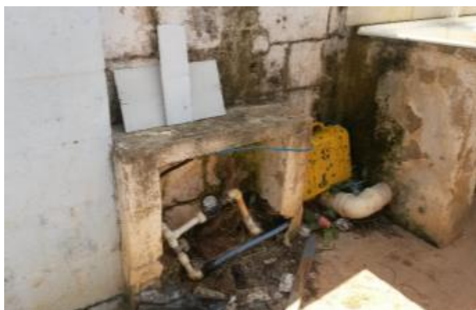
Figura 3 - Equipamento de medição instalado no Ponto 03 - Município de Afonso Cláudio, ES
