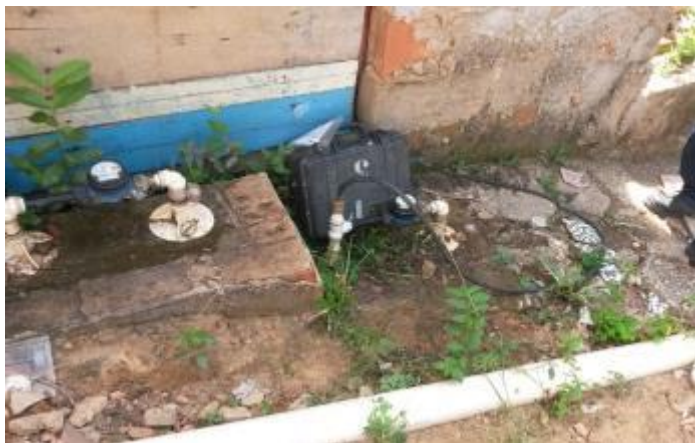
Figura 5 - Equipamento de medição instalado no Ponto 05 – Município de Afonso Cláudio, ES
