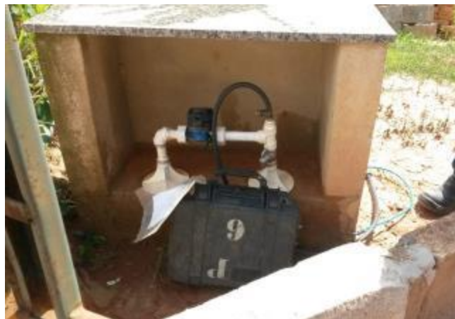
Figura 6 - Equipamento de medição instalado no Ponto 06 – Município de Afonso Cláudio, ES
