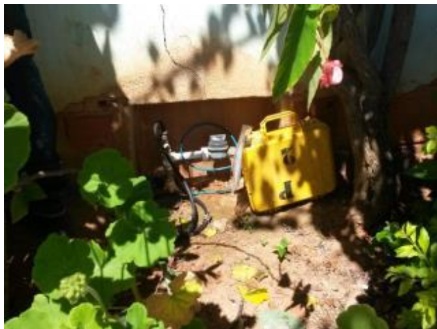
Figura 2 - Equipamento de medição instalado no Ponto 02 - Município de Afonso Cláudio, ES
