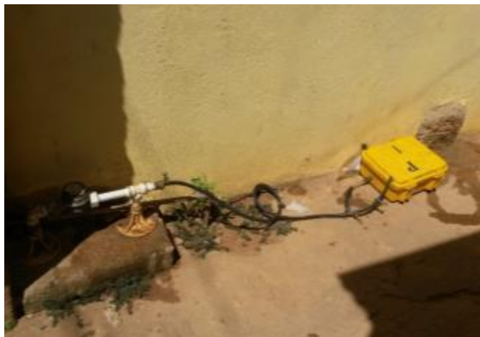
Figura 1 - Equipamento de medição instalado no Ponto 01 - Município de Afonso Cláudio, ES
