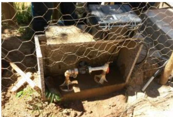
Figura 7 - Equipamento de medição instalado no Ponto 07 – Município de Afonso Cláudio, ES
