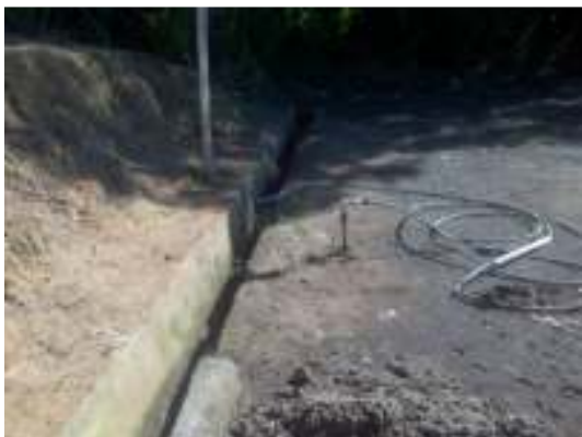
Figura 5 - Canaleta de drenagem do pátio da UGR.
