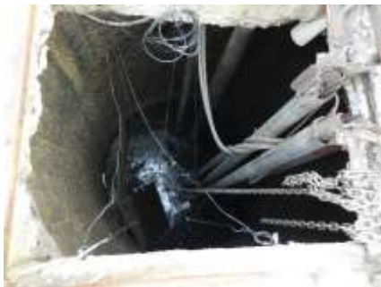
Figura 7 - Ausência de bomba reserva no poço de sucção.
