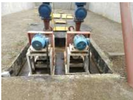
Figura 4 - Bomba reserva instalada.
