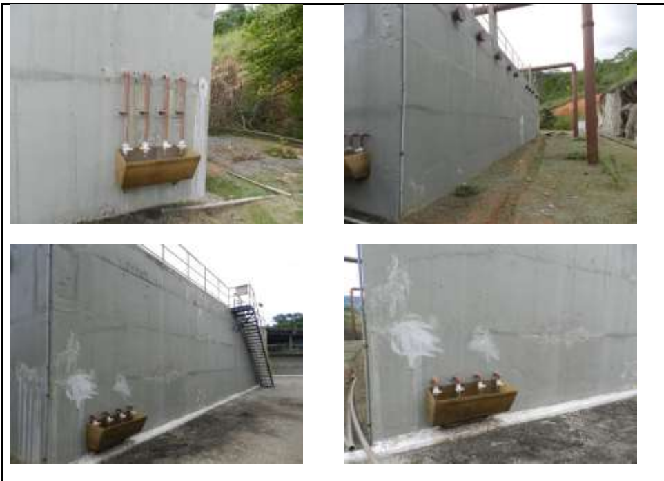
Figura 6 - Reator UASB da ETE Serra Sede sem pontos de infiltração.
