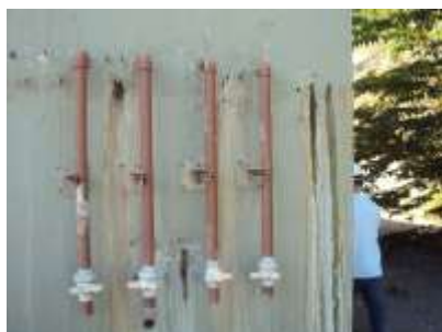
Figura 3 - Permanência de pontos com infiltração na estrutura dos reatores.
