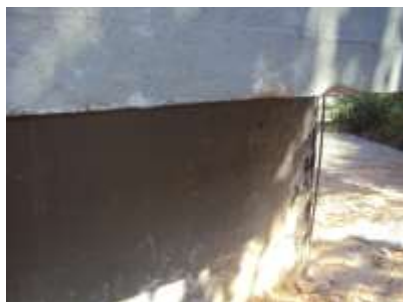
Figura 1 - Infiltração nos biofiltros e decantadores solucionada.
