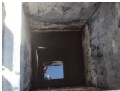
Figura 2 - Poço de chegada de efluentes livre de excesso de areia.
