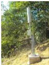
Figura 1 - Queimador de gases do reator instalado, será operado quando houver geração suficiente de gás.
