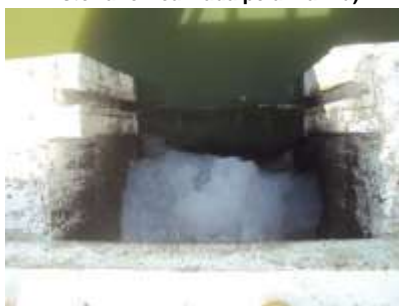
Figura 4 - Presença de espuma em excesso em ponto intermediário (ausência de espuma ao longo da lagoa facultativa).
