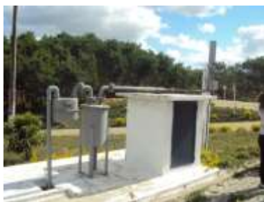
Figura 1 - Queimador de gases do reator UASB apto a operar.
