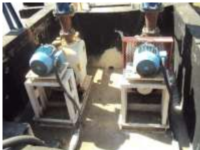
Figura 2 - Caixa de bomba livre de acúmulo de água pluvial.
