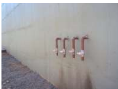
Figura 2 - Infiltração no reator eliminada.
