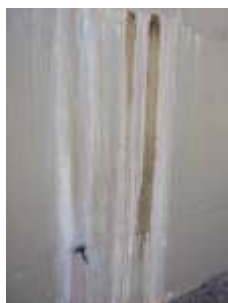
Figura 4 - Permanência de pontos com infiltração na estrutura dos reatores.
