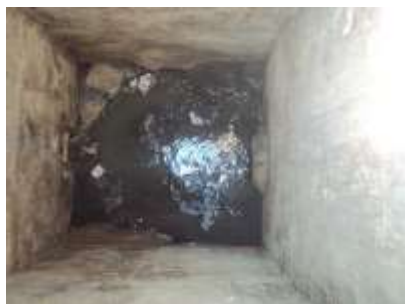
Figura 3 - Excesso de areia retirado do poço de chegada de efluentes.
