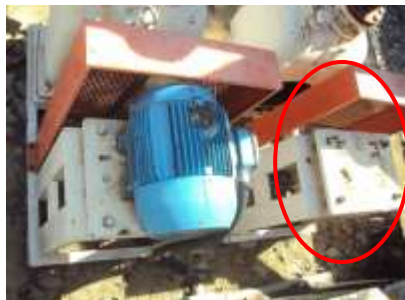
Figura 1 - Ausência de Bomba Reserva.
