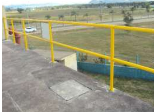
Figura 1 – Guarda-corpo do reator UASB restaurado.
