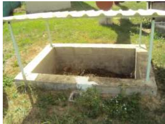
Figura 2 – Biofiltro inoperante (baixa vazão).
