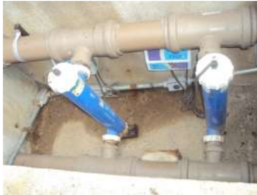
Figura 1 – Sistema de tratamento UV inoperante (baixa vazão de efluente).
