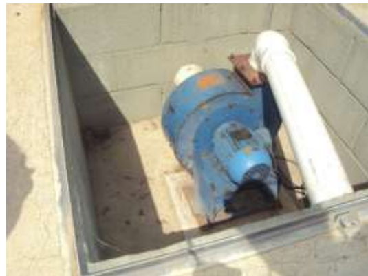
Figura 2 – Biofiltro inoperante (baixa vazão)
