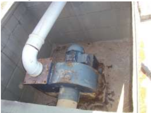
Figura 3 – Biofiltro inoperante (baixa vazão).
