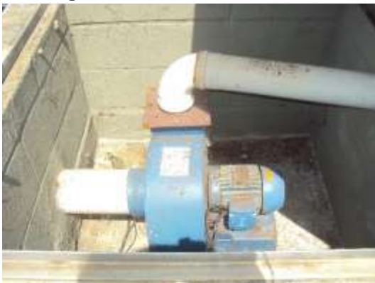
Figura 3 – Biofiltro inoperante (baixa vazão).
