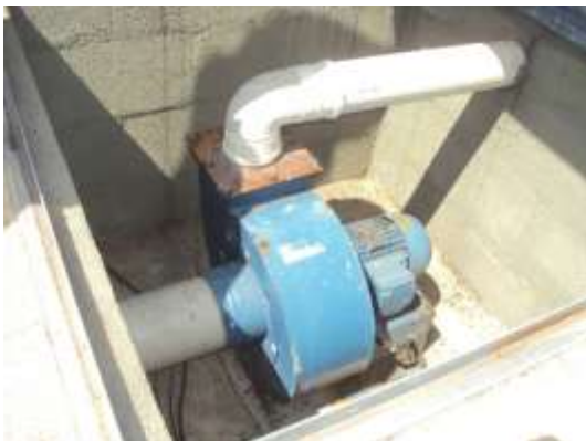
Figura 3 – Biofiltro inoperante (baixa vazão).
