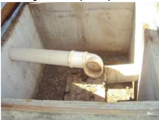
Figura 3 – Ausência de motor do biofiltro.
