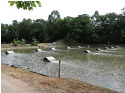
Figura 1 - Aeradores - ETE Laranjeiras.
