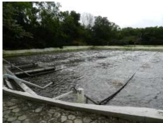
Figura 2 - Aeradores - ETE Valparaíso.
