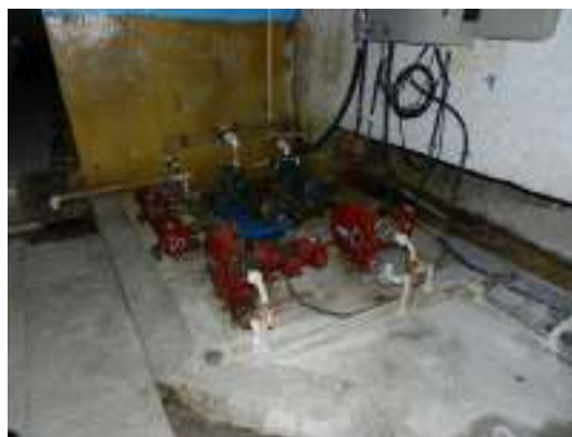
Figura 2 - Conjuntos Motor-Bomba para o Sulfato de Alumínio e para a Cal.
