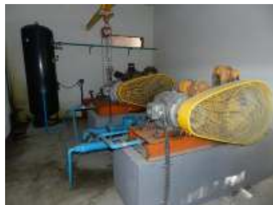
Figura 15 - Compressores de ar.
