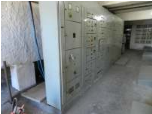
Figura 8 - Painel de Comando.
