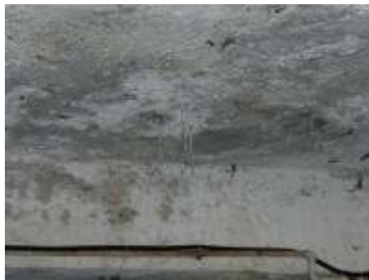
Figura 4 - Infiltrações no teto do local que comporta a bombona de polieletrólito e os conjuntos motor-bomba do sulfato de alumínio e cal.
