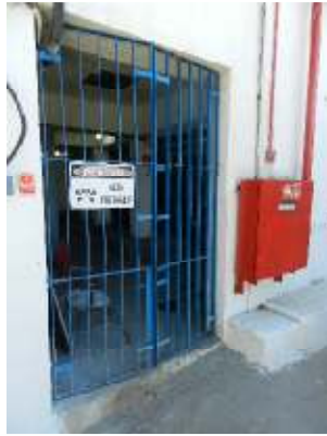
Figura 6 - Sinalização de risco de choque elétrico.
