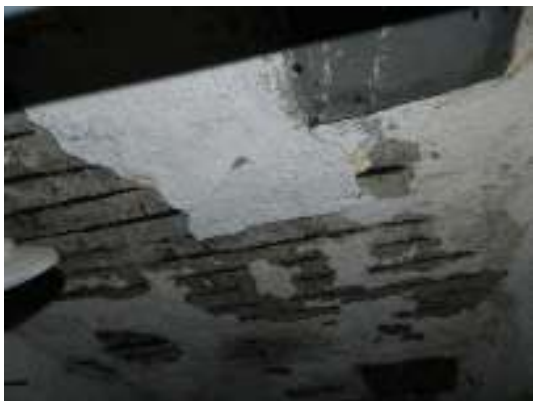
Figura 3 - Ferro estrutural exposto no teto do local que comporta a bombona de polieletrólito e os conjuntos motor-bomba do sulfato de alumínio e cal.
