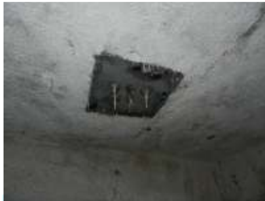
Figura 9 - Infiltrações no teto do local que comporta a elevatória de água para lavagem dos filtros.
