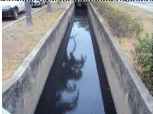
Figura 7 - Canal da costa, ao lado da Elevatória de esgoto Bruto VVP, onde havia possibilidade de extravasamento.
