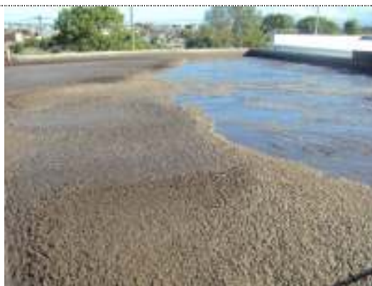
Figura 2 – Um dos tanques de aeração da ETE Araçás.
