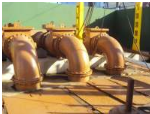
Figura 4 - Elevatória que foi paralisada durante manutenção da ETE Araçás.
