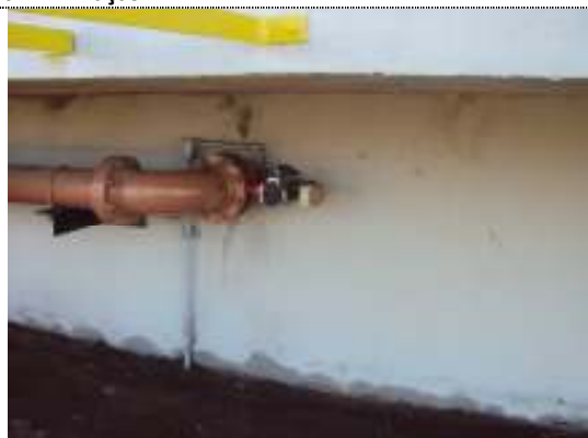
Figura 3 - Válvula de retirada do lodo de um dos tanques aerados da ETE Araçás.
