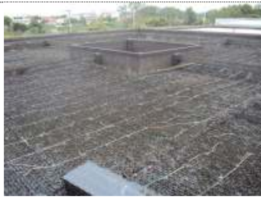
Figura 6 - Tanque D da ETE Araçás que também precisou ser esvaziado durante a manutenção.
