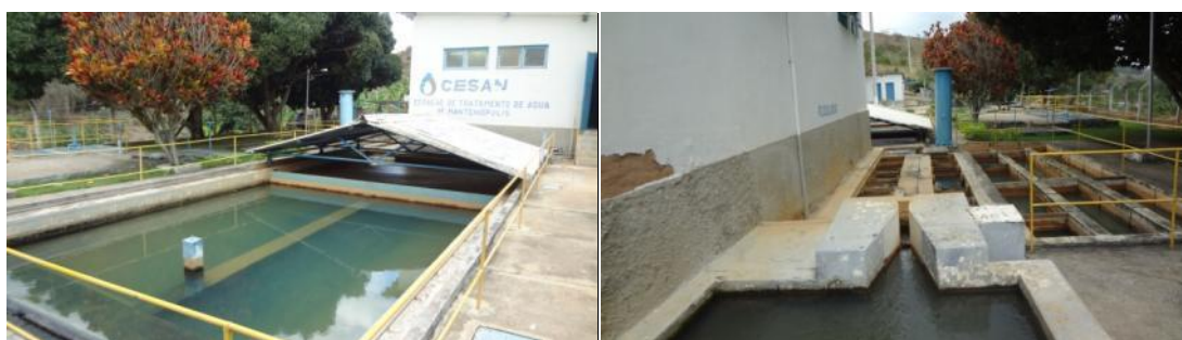
Figura 3-18 - Estação de Tratamento de Água - Sede.
