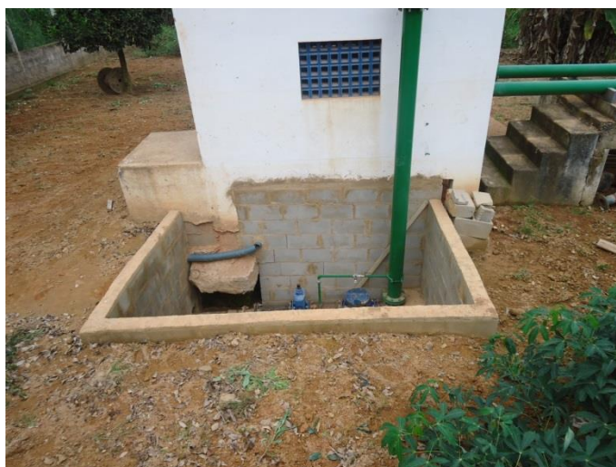
Figura 2 - Bomba de adução - capacidade 20cv
