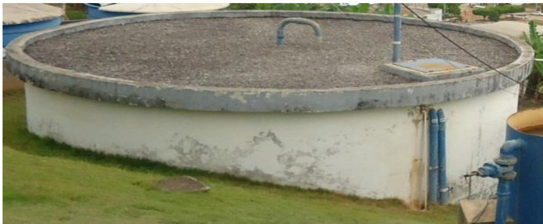
Figura 3 - Reservatório de abastecimento público (capacidade - 100 m 3 )
