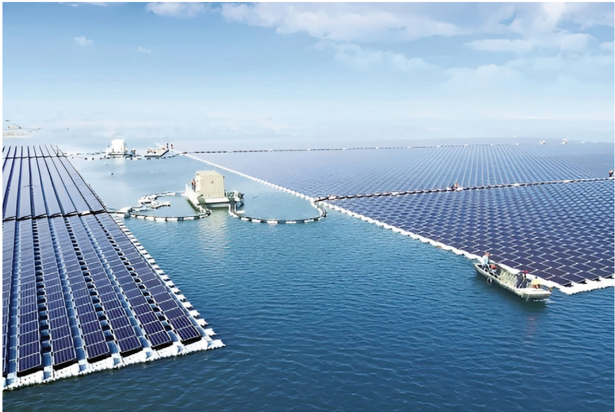
FIGURA 10.13 Usina solar fotovoltaica flutuante na China, 40 MWp
