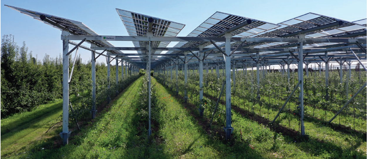
FIGURA 10.20 Sistema agrivoltaico instalado em substituição a estufa do morangueiro 3
