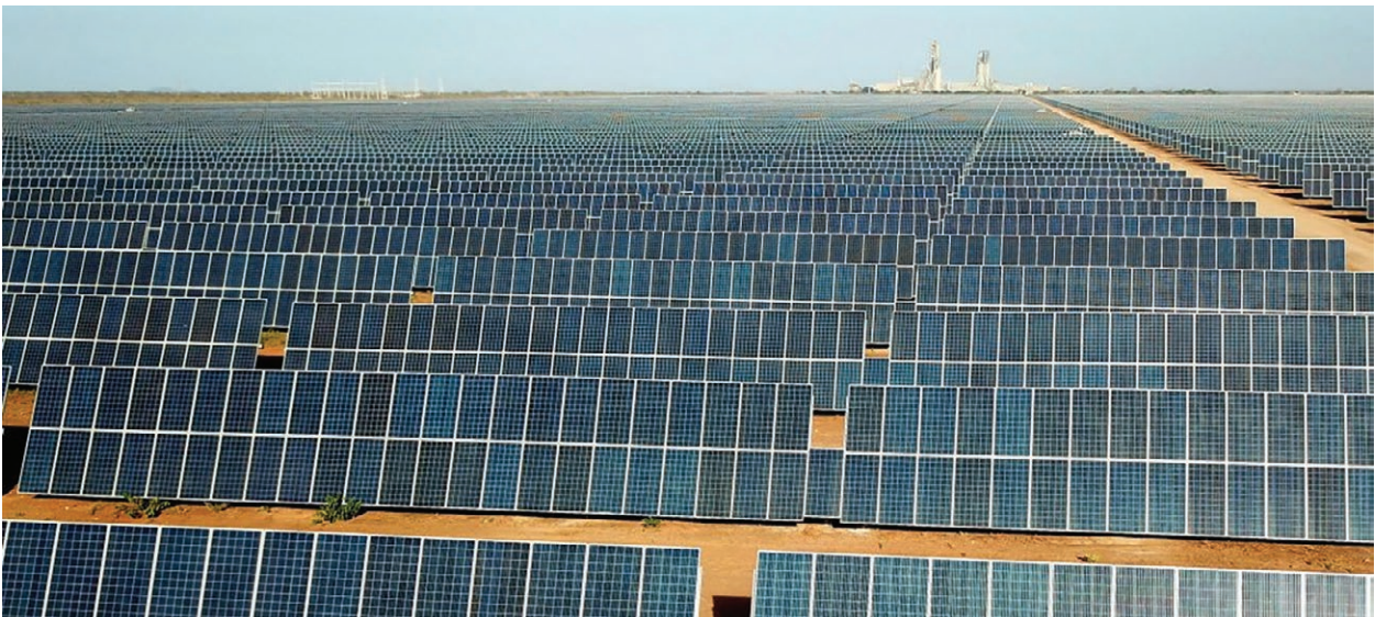
FIGURA 10.12 Usina Solar Apodi, Quixeré, CE, 132 MWp
