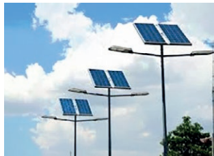
b) Iluminação pública
