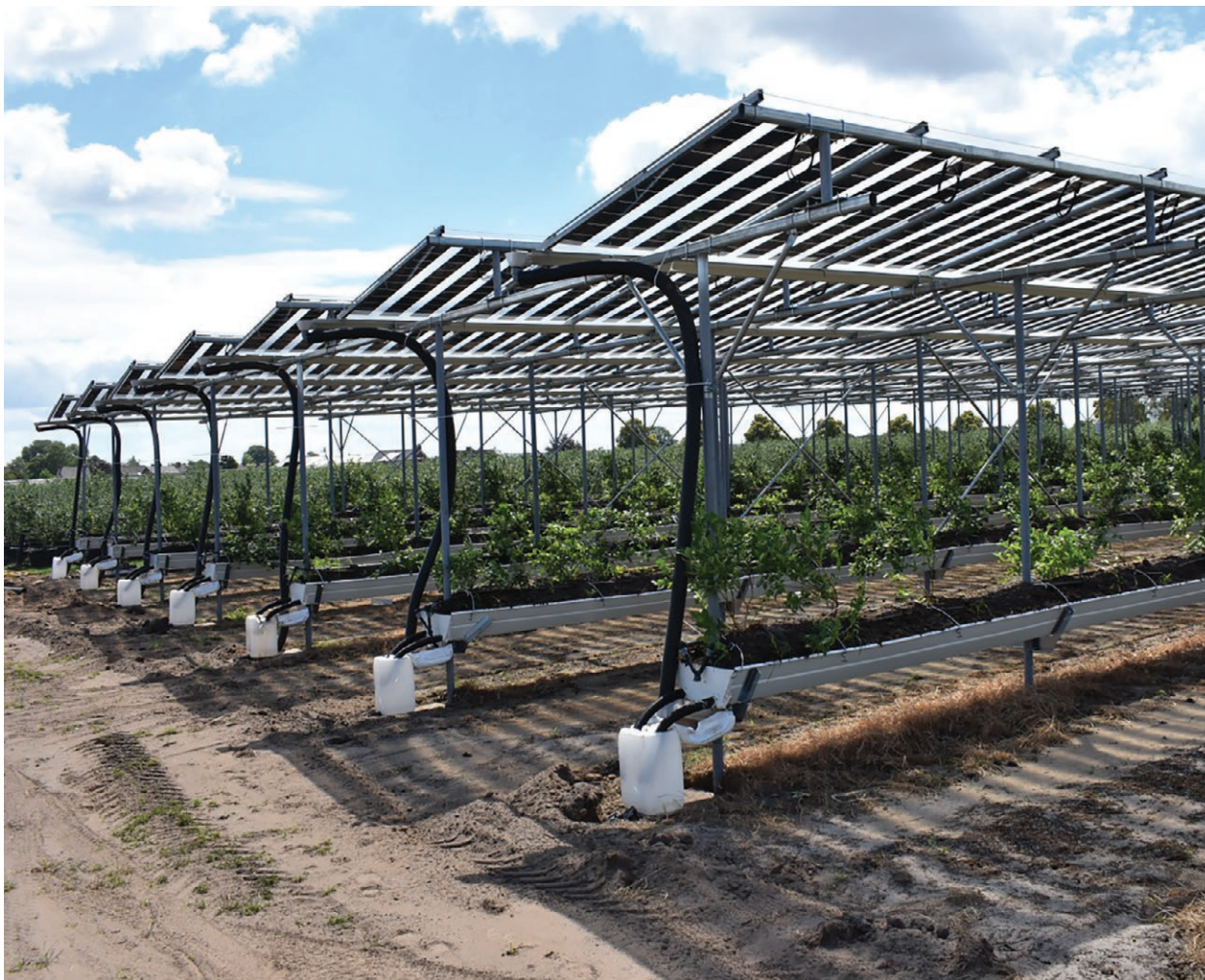
FIGURA 10.19 Sistema agrivoltaico instalado em substituição a estufa do morangueiro 2
