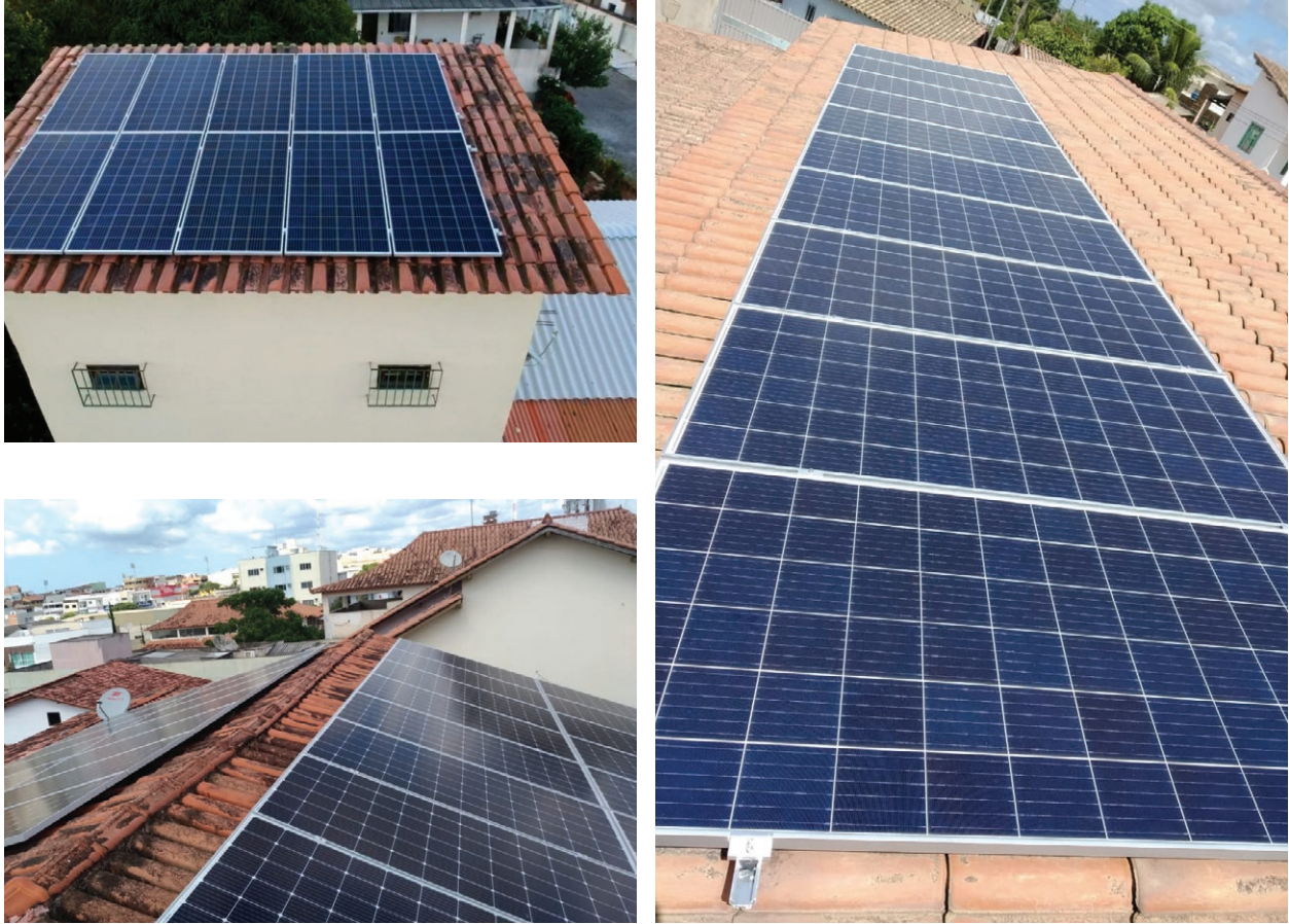
FIGURA 4.1 Fotos de residências com sistemas fotovoltaicos no Espírito Santo
