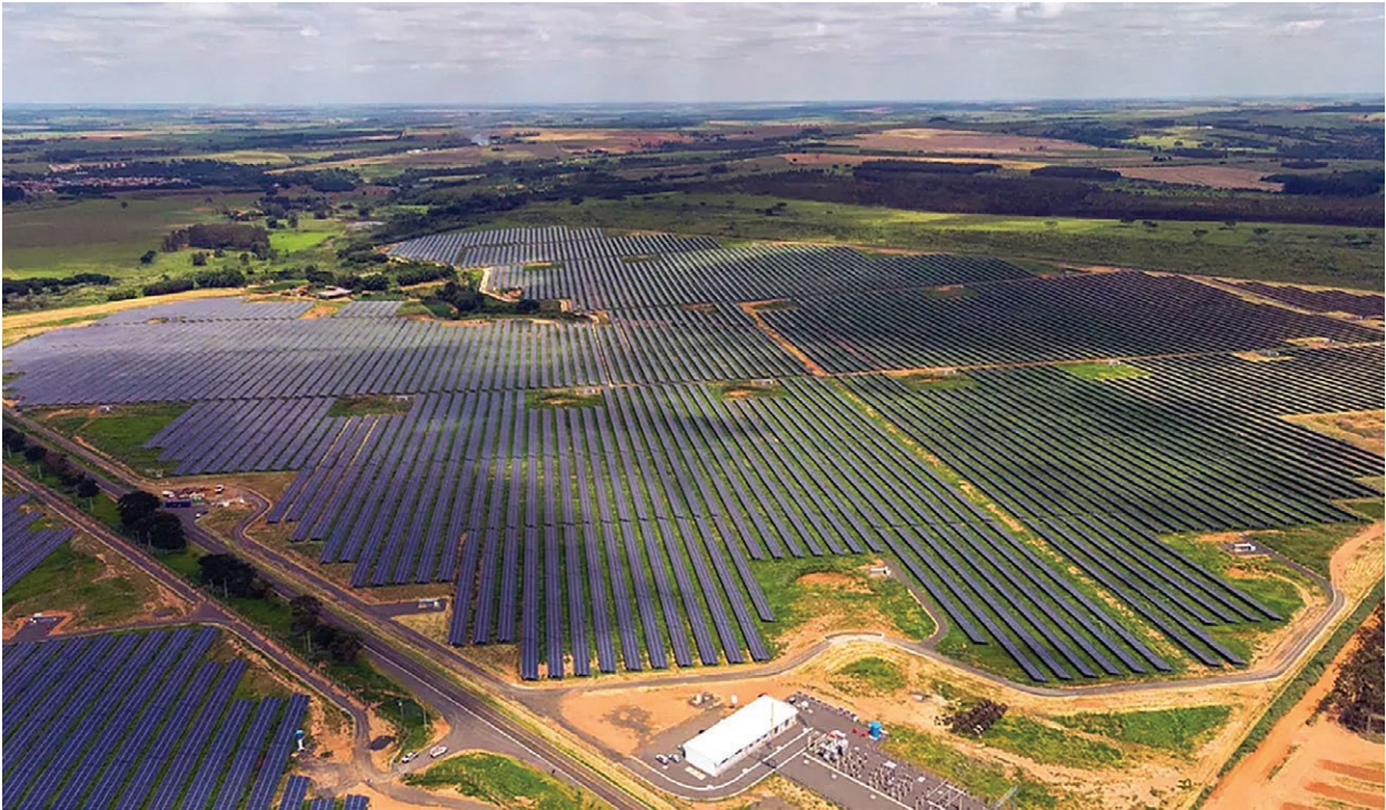
FIGURA 10.11 Usina Solar Guaimbê, Guaimbê, SP, 150 MWp
