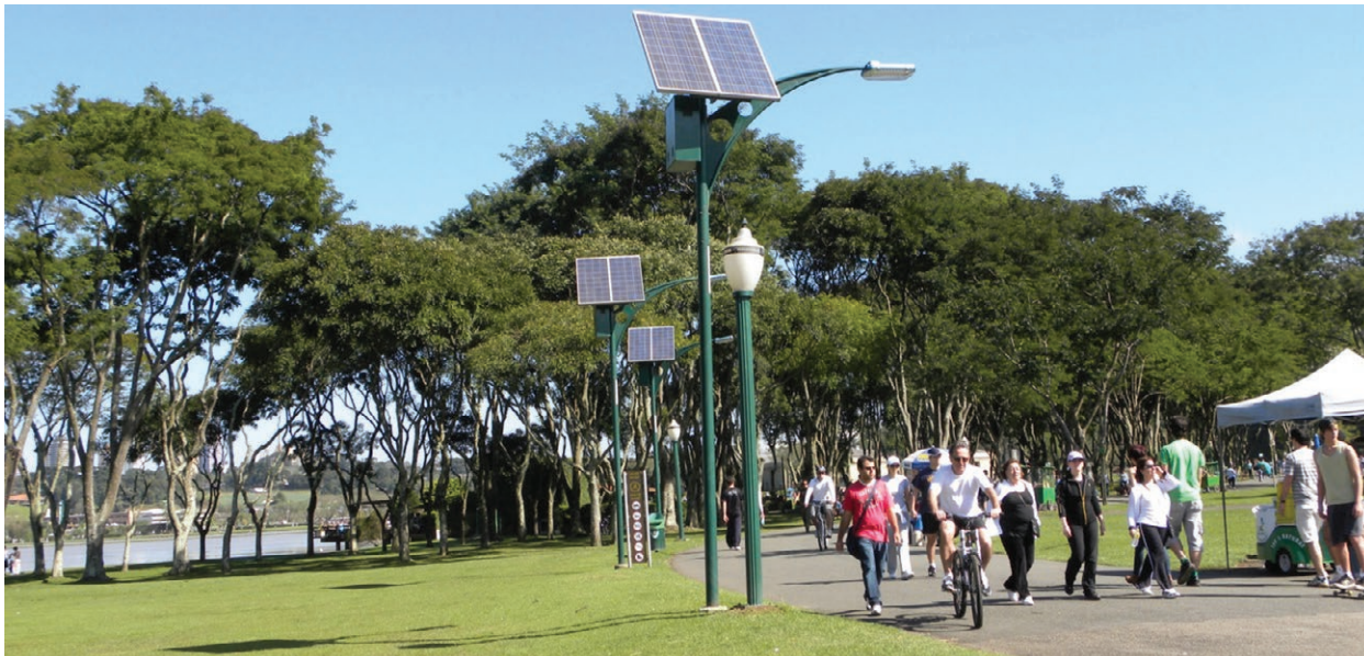
FIGURA 10.22 Energia Solar na Iluminação Pública, no Parque Barigui, Curitiba, PR
